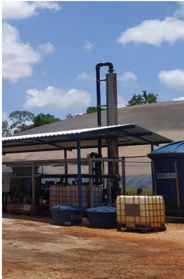
Figura 10 – Lavador de gases
