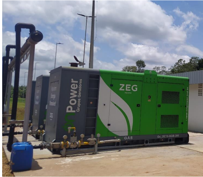
Figura 9 – Geradores de energia
