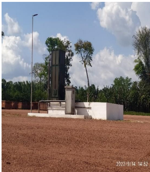
Figura 5 – Torre de Resfriamento
