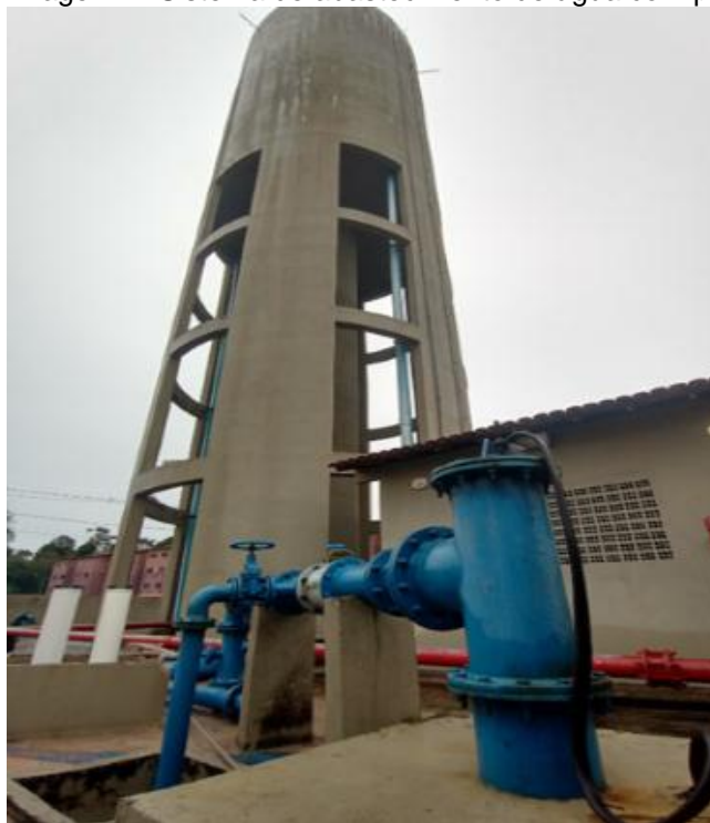
Imagem 1- Sistema de abastecimento de água com poço
