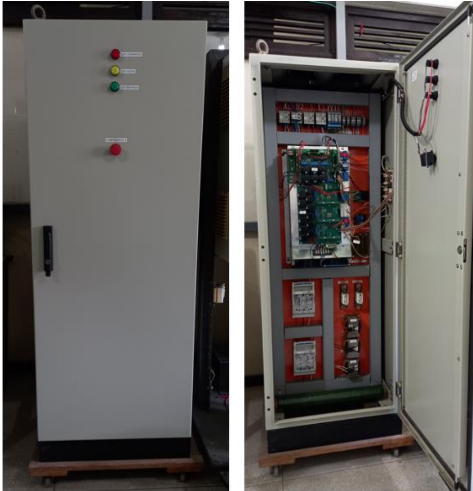
Figura 2.2 — Frente do painel modular à esquerda e parte interna do conversor multinível montado à direita, vista frontal.
