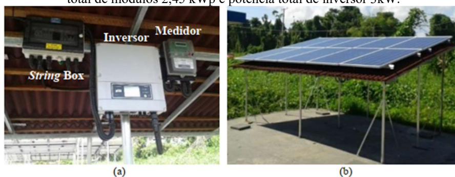
Figura 1.6 – (a) Disposição do inversor, caixa de proteção e medidor; (b) Vista geral do gerador FV. Potência total de módulos 2,45 kWp e potência total de inversor 3kW.
