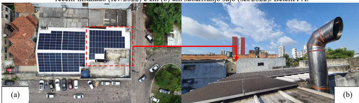
Figura 1.10 – Sombreamento total de alguns subarranjos FV com oito meses de operação. Em (a) o GFV limpo recém-instalado (fev/2022) e em (b) um subarranjo sujo (set/2022). Belém/PA.
