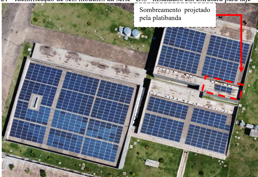
Figura 3.21 - Identificação de seis módulos da série “D.8” instalados em estrutura para laje – Sistema 4.
