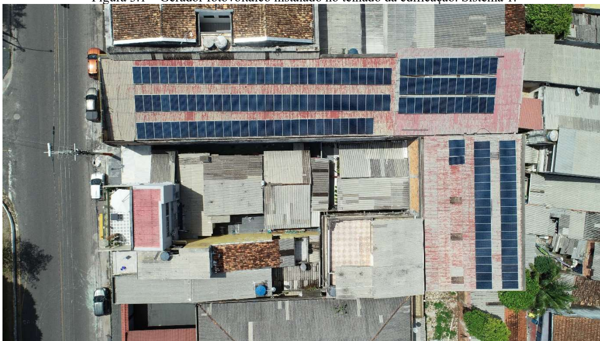
Figura 3.1 – Gerador fotovoltaico instalado no telhado da edificação. Sistema 1.
