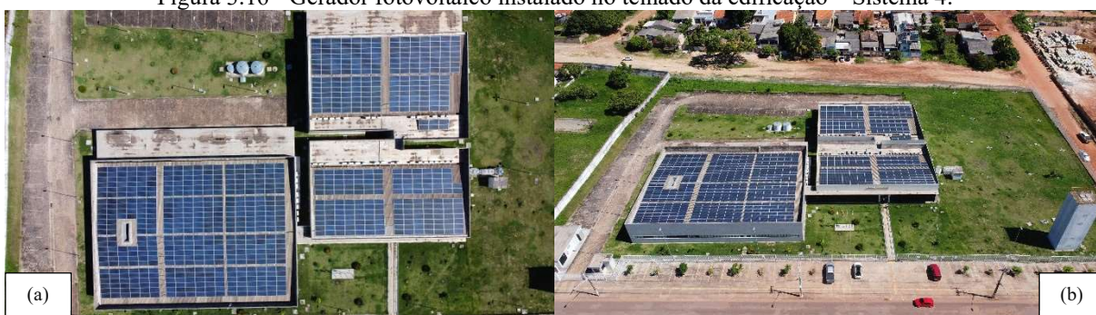
Figura 3.16 - Gerador fotovoltaico instalado no telhado da edificação – Sistema 4.
