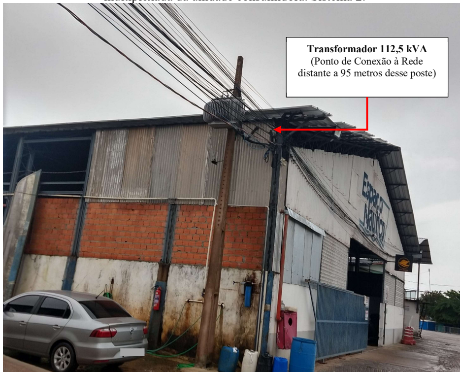
Figura 3.9 – Local de instalação do transformador "rebaixador" para conexão à rede do SFCR, na rede BT multiplexada da unidade consumidora. Sistema 2.
