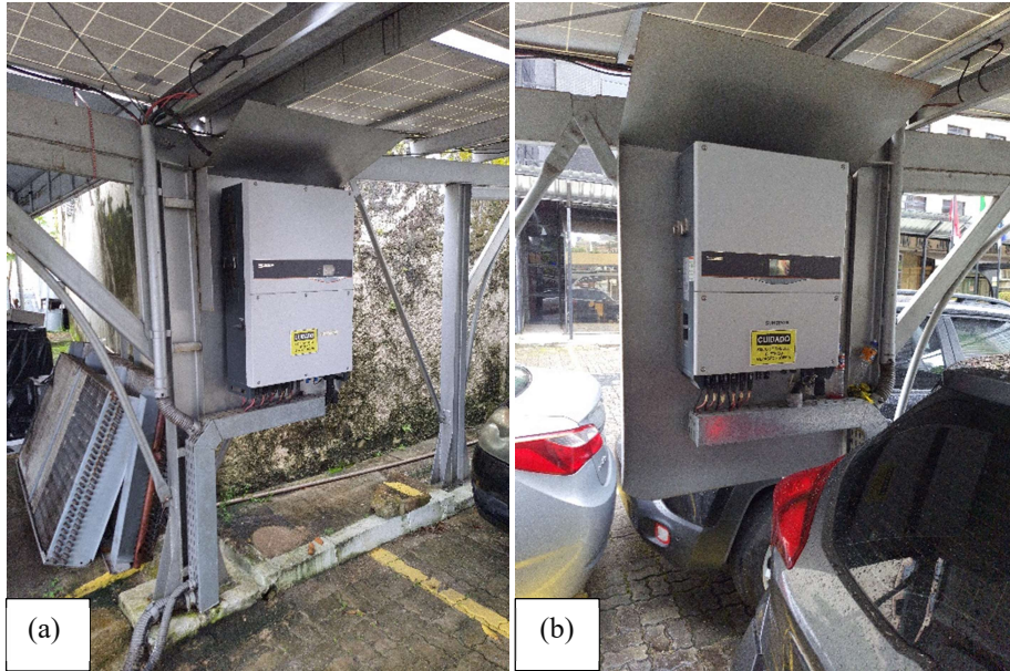
Figura 3.23 – Inversores, 60 kW (“a”) e 36 kW (“b”), instalados na estrutura carport do gerador fotovoltaico – Sistema 5.
