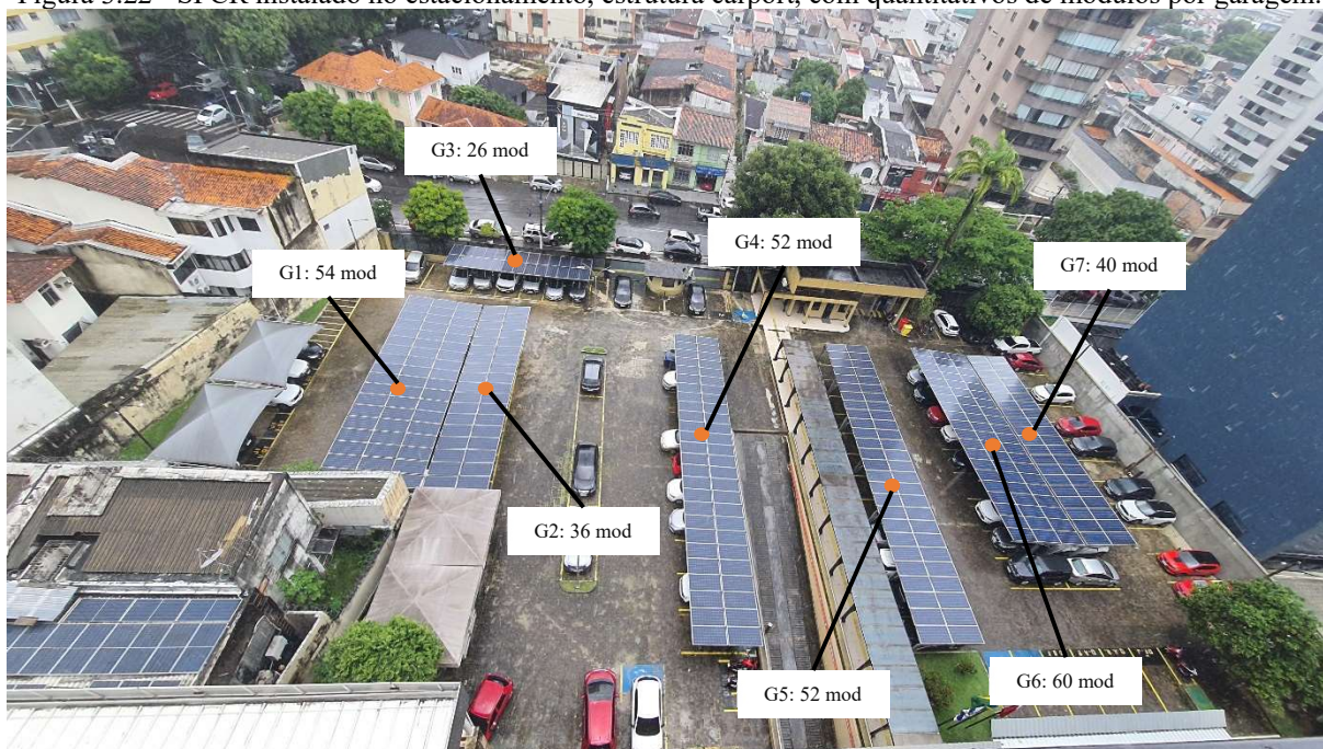
Figura 3.22 - SFCR instalado no estacionamento, estrutura carport , com quantitativos de módulos por garagem.
