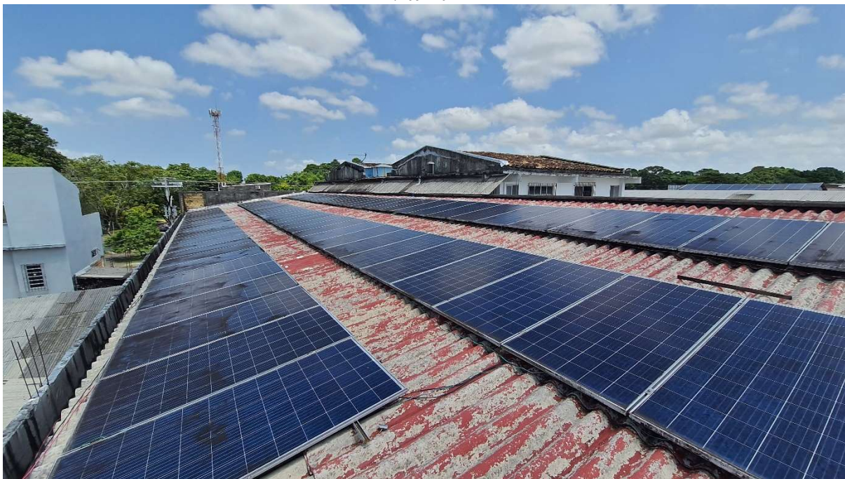
Figura 4.27 – Arranjo FV com muita sujidade, Sistema 1 (53,46 kWp). Registro fotográfico realizado em 17/09/2022.
