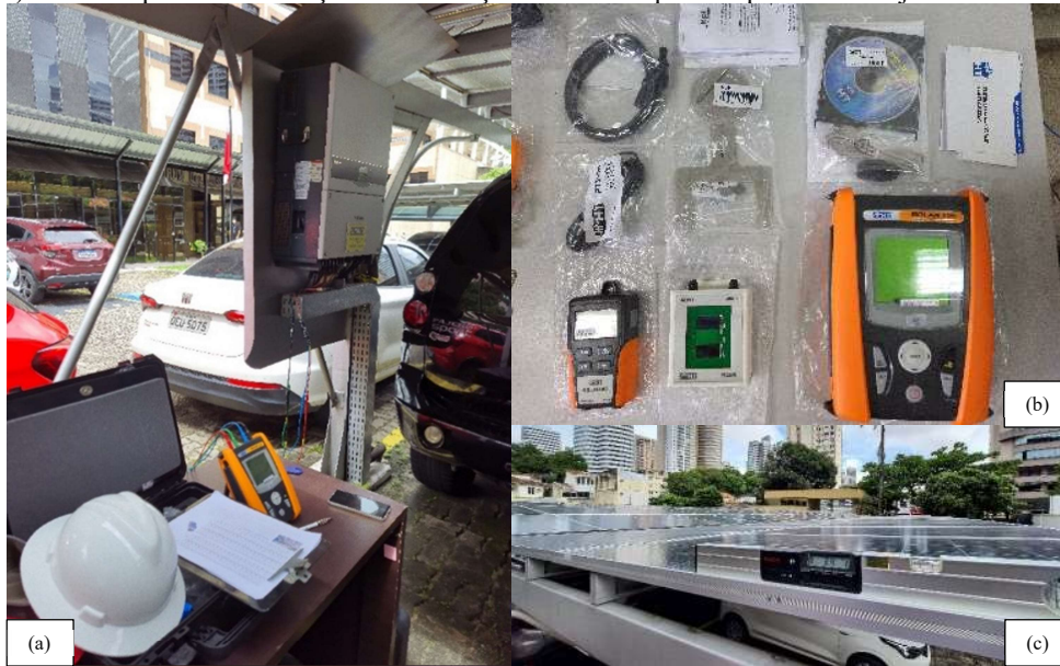
Figura 4.1 – Montagem dos equipamentos (“a”) e acessórios (“b”) para ensaio de curva I-V, e inclinômetro (“c”) utilizado para determinação da inclinação das séries que compõem o arranjo B do Sistema 5.
