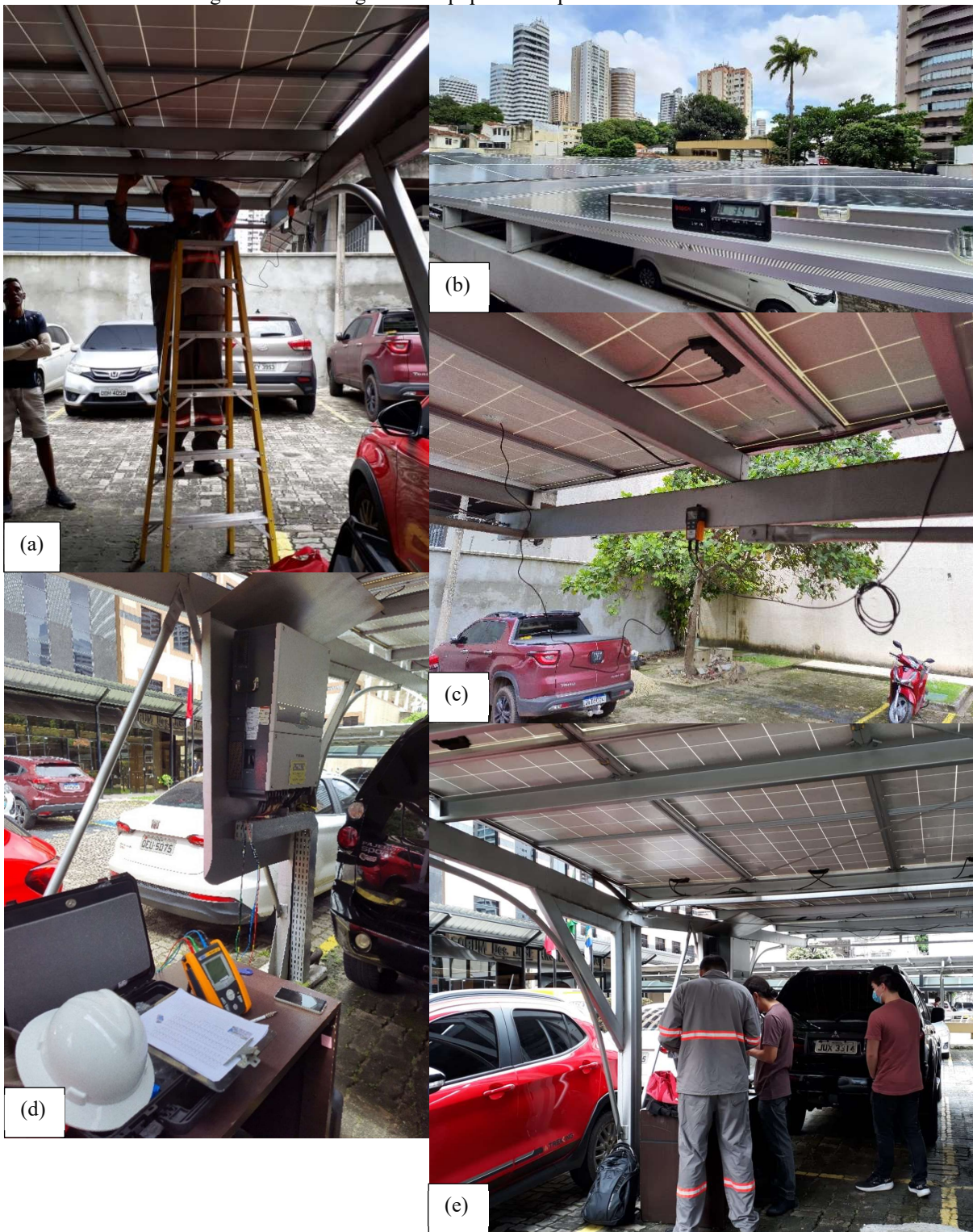
Figura 4.2 - Montagem dos equipamentos para ensaios de curva IxV.
