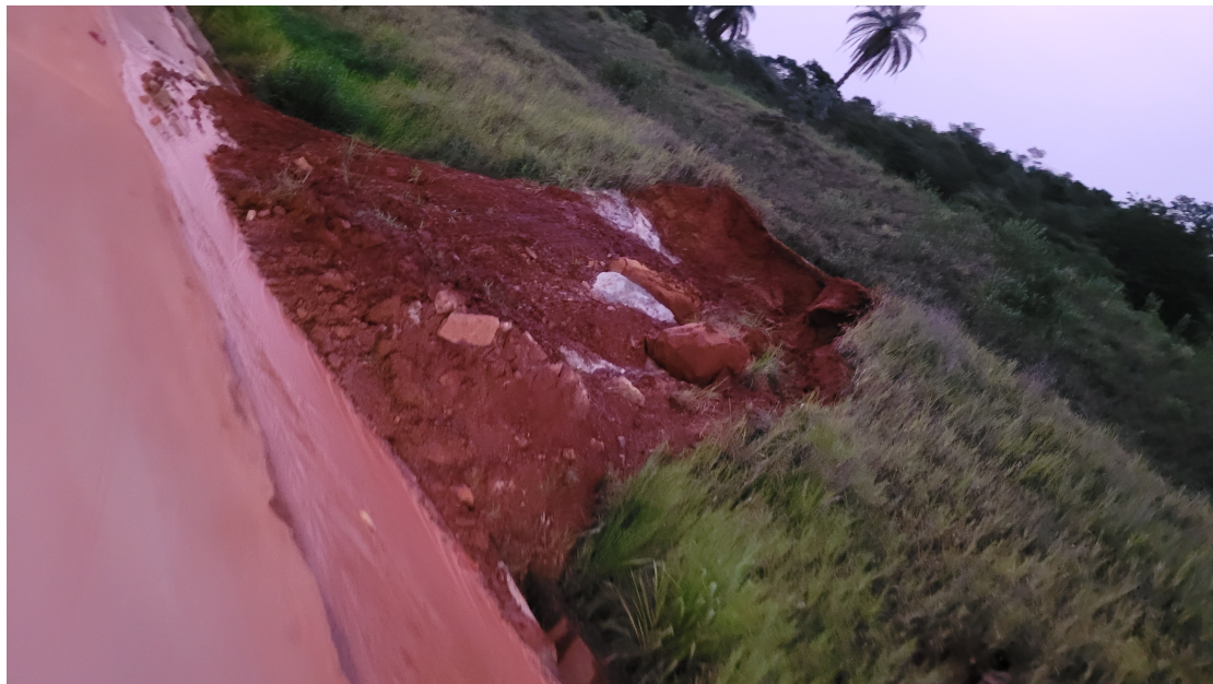
Figura 1. Deslizamento às margens da rodovia 381, Brasil 2022.
