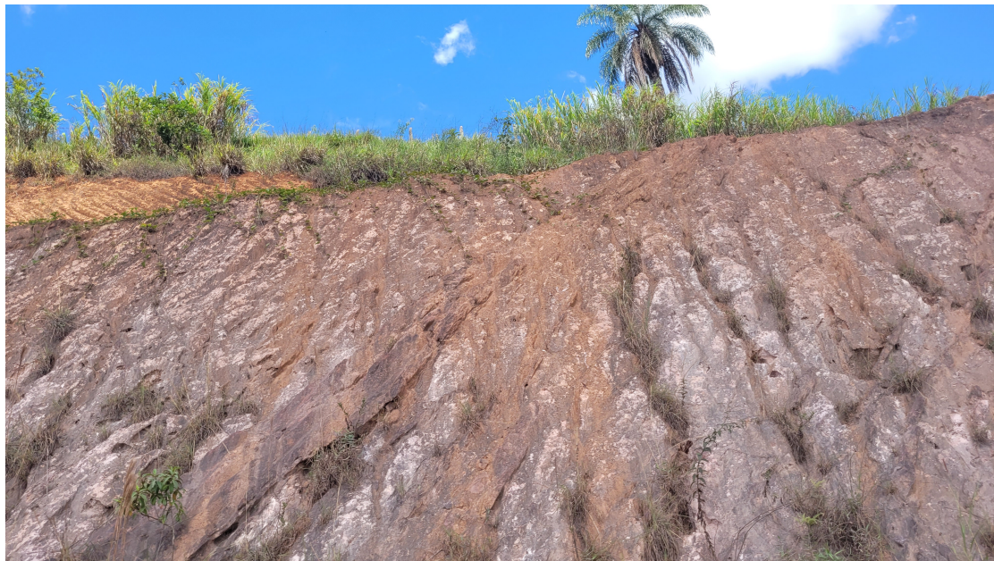
Figura 2. Erosão na superfície de taludes às margens da rodovia 381, Brasil 2022.
