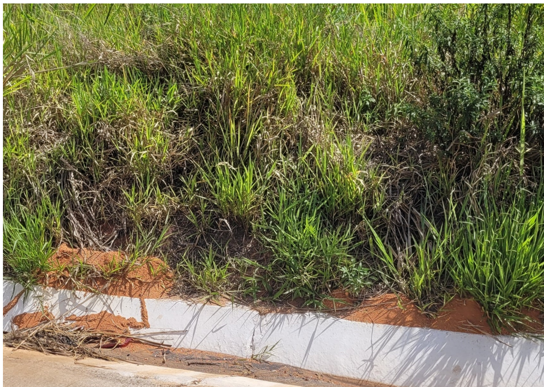
Figura 4. Ação biológica de formigueiro em taludes às margens da rodovia 381, Brasil 2022.
