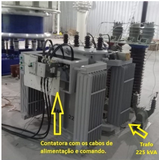
Figura 20. Transformador de 225 kVA e contatora.
