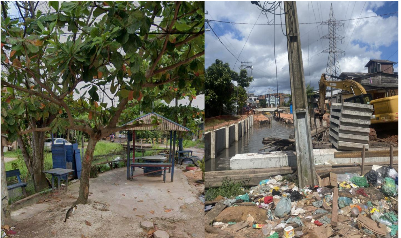
Figura 22. Antes e depois da intervenção da obra de macrodrenagem Passagem Comissário com Rua Vera Cruz, Terra Firme, Belém-PA
