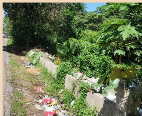
Figura 47: Muro do PEUT no bairro de Águas Lindas em estado de destruição e descarte irregular de lixo em 2023
