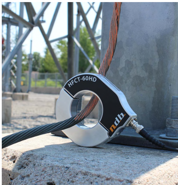
Figura 3 – Dispositivo HFCT acoplado ao cabo de aterramento em uma subestação.
