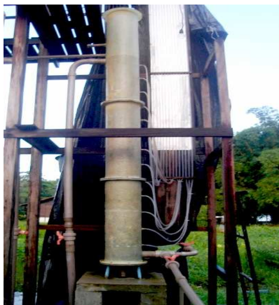
Fotografia 17 - Corte interno do filtro de camada simples da ETA - Piloto. Fonte: Direta
