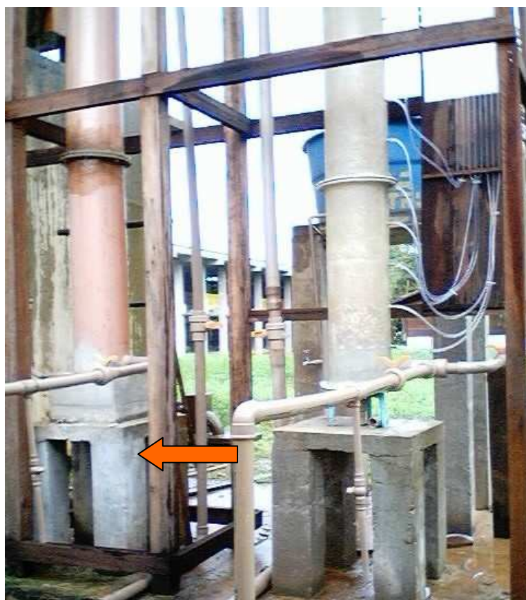
Fotografia 20 - Base de concreto para apoio do Leito de Contato da ETA-Piloto. Fonte: Direta.
