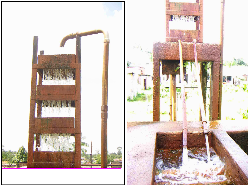
Fotografia 10 - Aerador tipo tabuleiro e filtro, respectivamente, localizado no Bairro do tapanã na ETA Aldo Almeida
