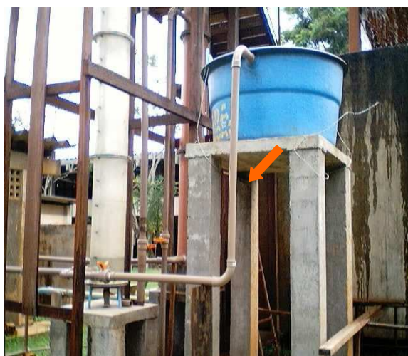
Fotografia 27 - tubulações de saída do filtro rápido descendente da ETA-Piloto.
