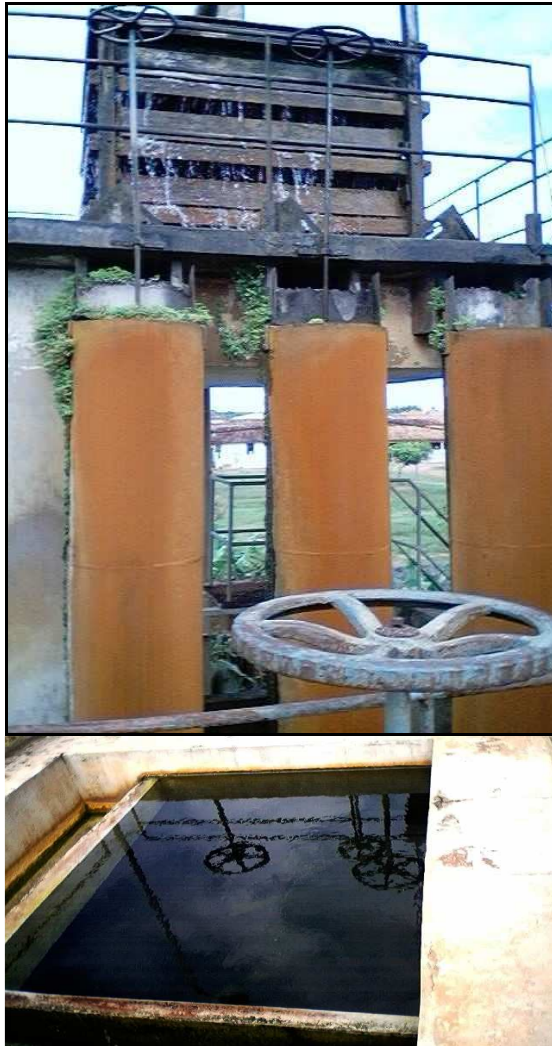
Fotografia 11 - Aerador tipo tabuleiro e Filtro Rápido, localizado no Bairro do Tapanã na ETA Cordeiro de Farias
