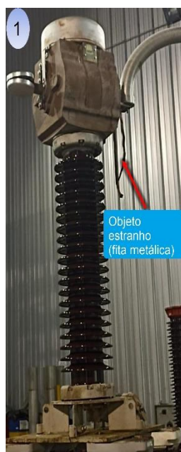
Figura 8: Registro no ensaio do TC de 145 kV.
