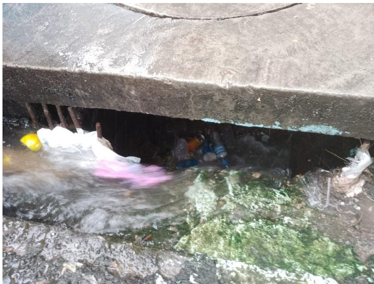
Figura 2 – Boca de Lobo sem a presença do gradil de retenção que poderia impedir o acesso de rejeitos as galerias
