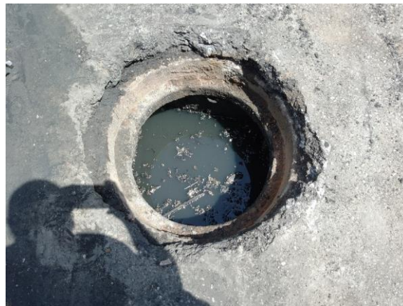
Figura 22 – Obstrução de sistema de esgoto
