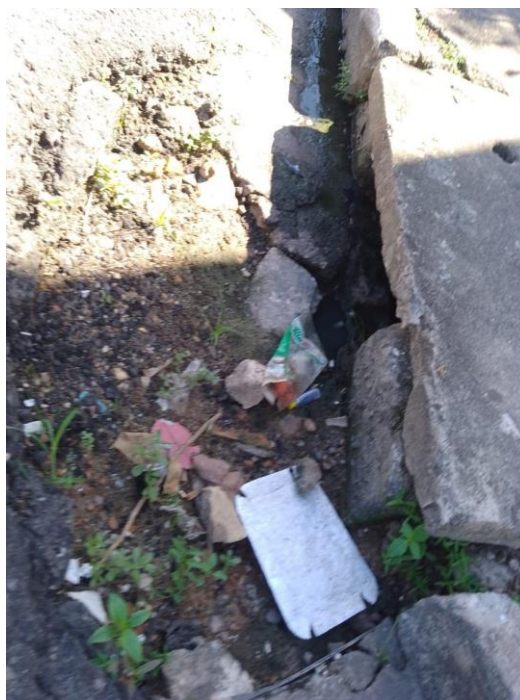
Figura 3 – As situações em que as Bocas de Lobo se encontram, favorecem o entupimento das galerias que potencializam as situações de enchentes, inundações e alagamentos
