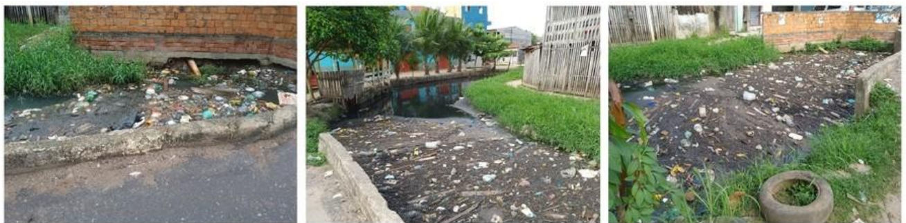
Figura 10 – Acúmulo de rejeitos no canal de drenagem no trecho da Rua Caraparú com a Rua Augusto Corrêa
