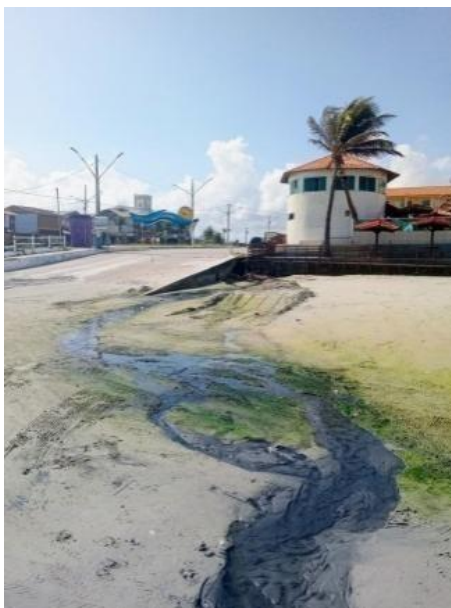
Figura 15: Esgoto saindo das tubulações e desaguando diretamente na praia do Atalaia.
