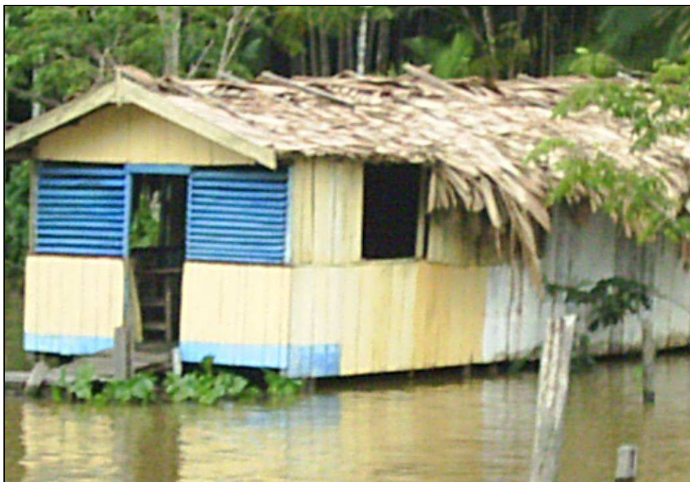
Fotografia 27: Escola da Rede Municipal de Ensino de Breves no meio rural ribeirinho, quase invadida pela cheia do rio. Fonte: Leão e Farias, 12/01/2007.
