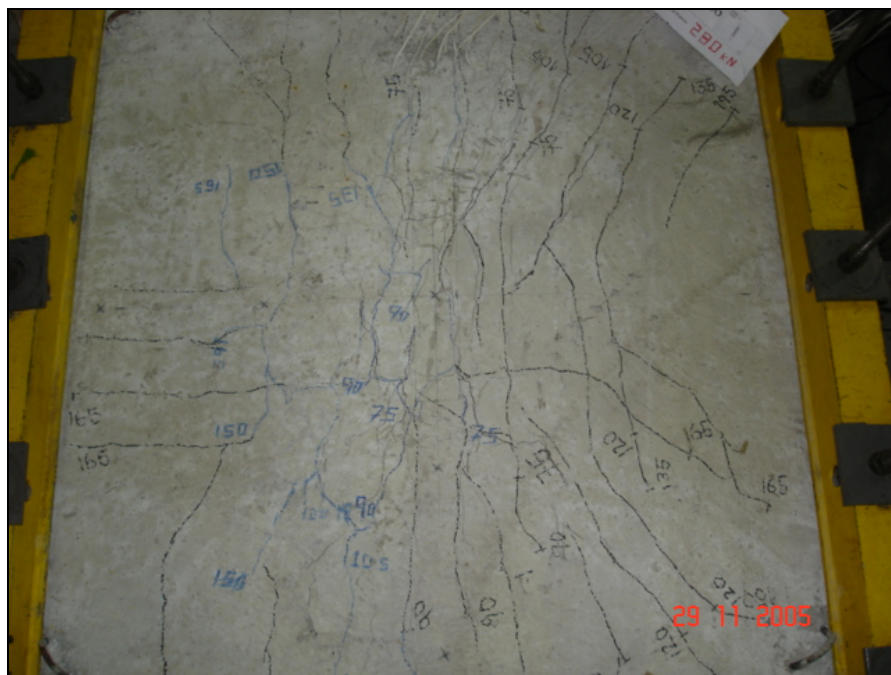
Figura 4.45 – Mapa de fissuração da laje L6
