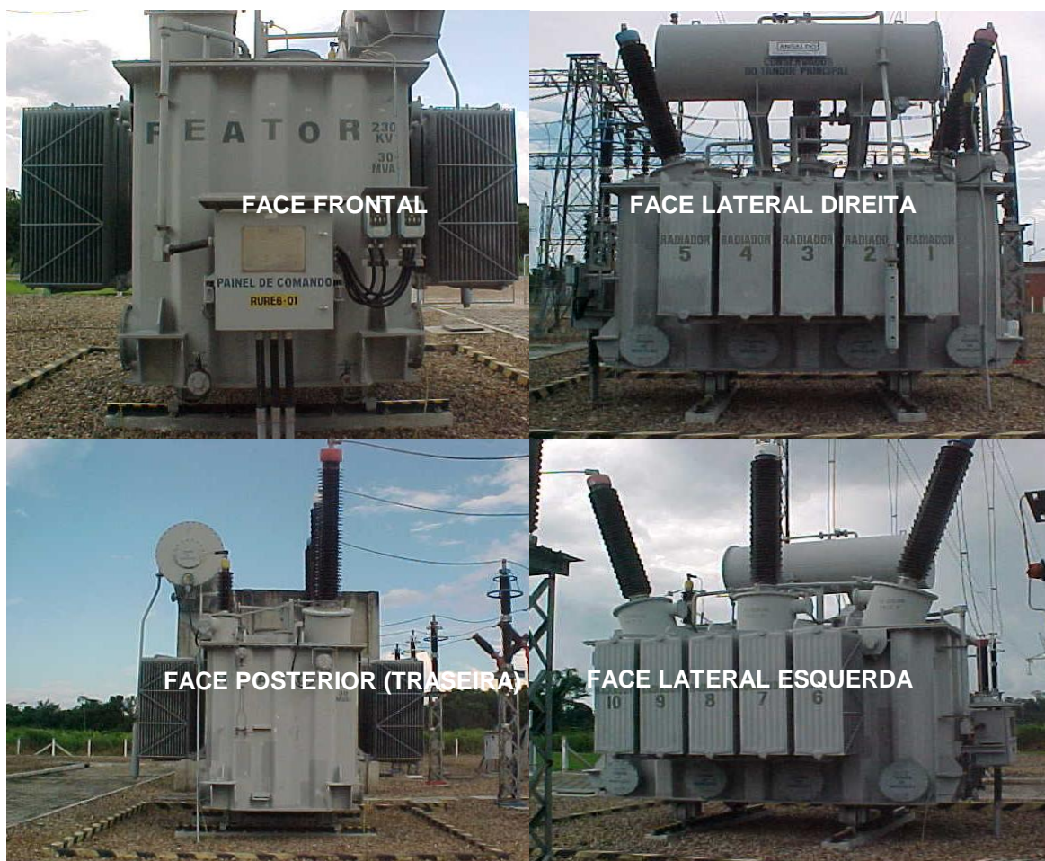
Figura 2.3. Reator elétrico trifásico 30 MVar . 242 MVA, do fabricante Ansaldo Coemsa.
