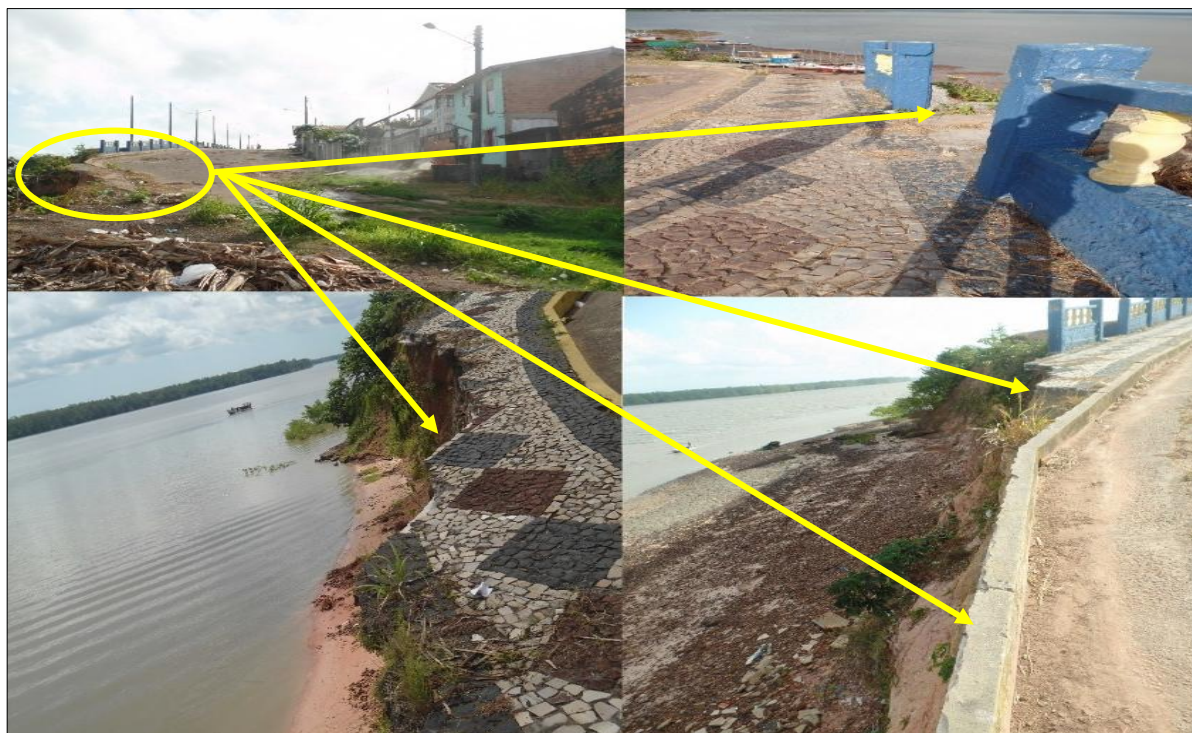
Figura 44: Erosões na orla da cidade em 2015, bairro do Itacoã, Maracanã/ PA
