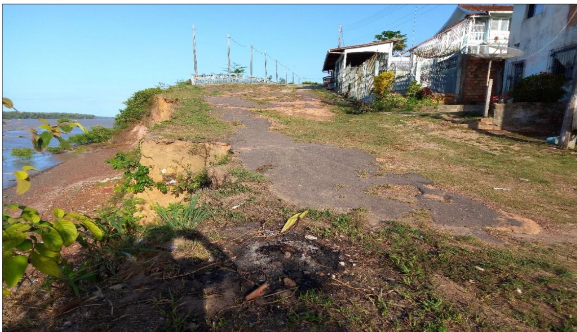
Figura 45: Erosões na orla da cidade em 2023, bairro Itacoã, Maracanã /PA
