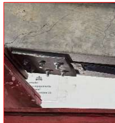
d) Det. 3 – Escorregamento
