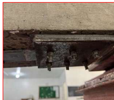
d) Det. 3- Escorregamento
