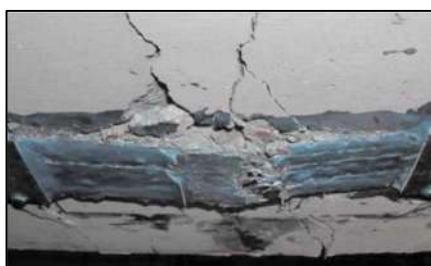
a) Ruptura do FRP (S2)
