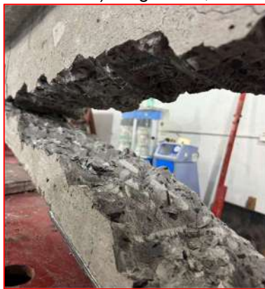
c) Det. 2- Delaminação do CC
