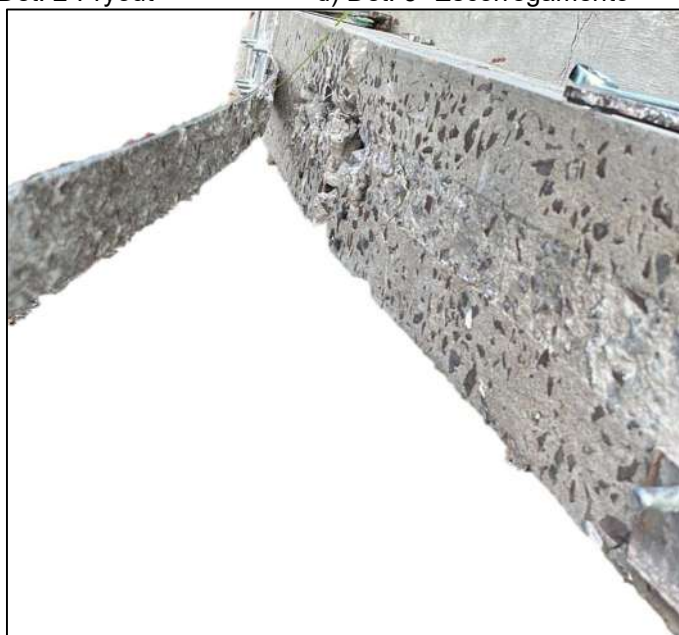
f) Destacamento do concreto
