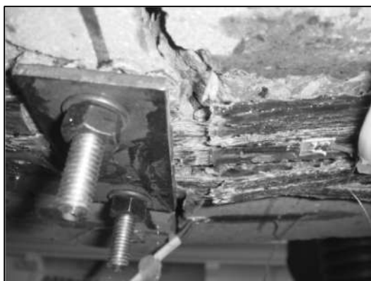
Figura 2.18 - Falha por Ruptura do FRP. Wu et al. , (2011).
