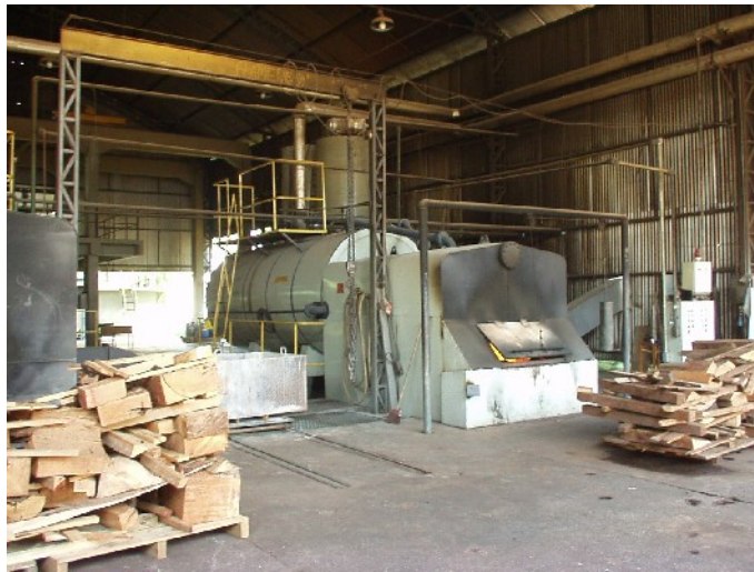
Figura 4 – Usina termoleléricas – (caldeiras)
