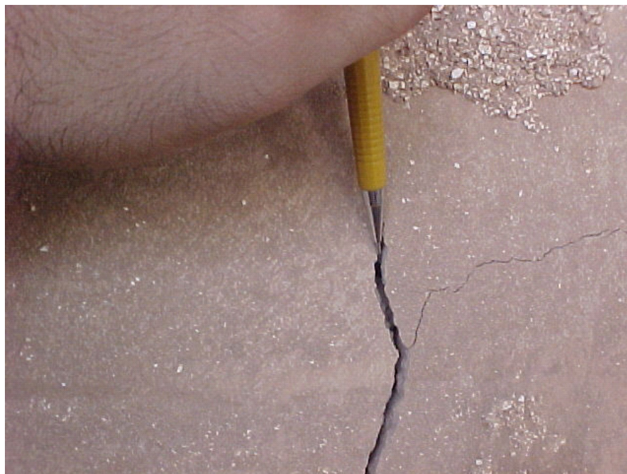
FIGURA 3.12 – Detalhe da trinca na parede de concreto isolante
