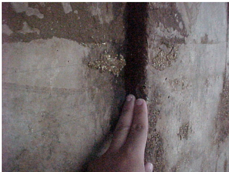
FIGURA 3.5 – Detalhe do efeito de deformação torcional na parede de concreto armado.
