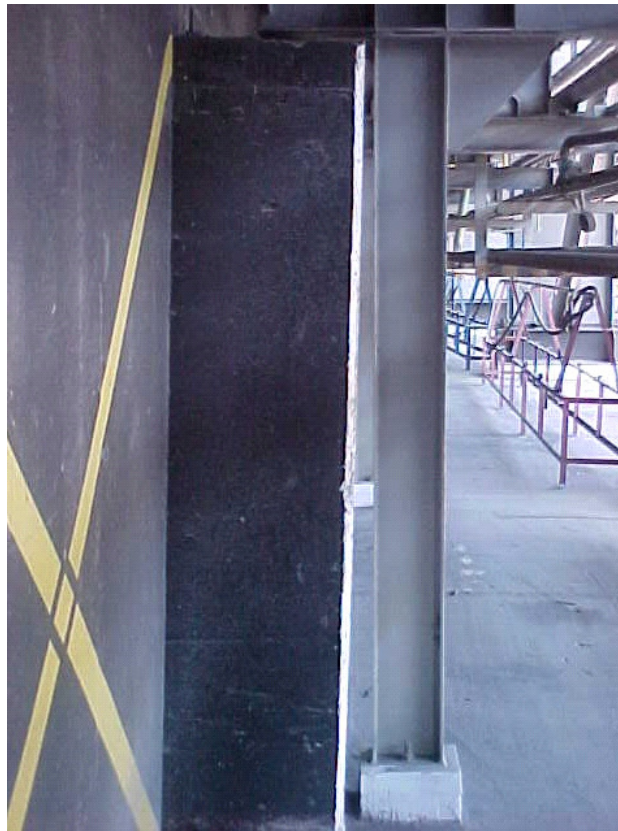
FIGURA 3.4 – Parede de concreto armado deformada
