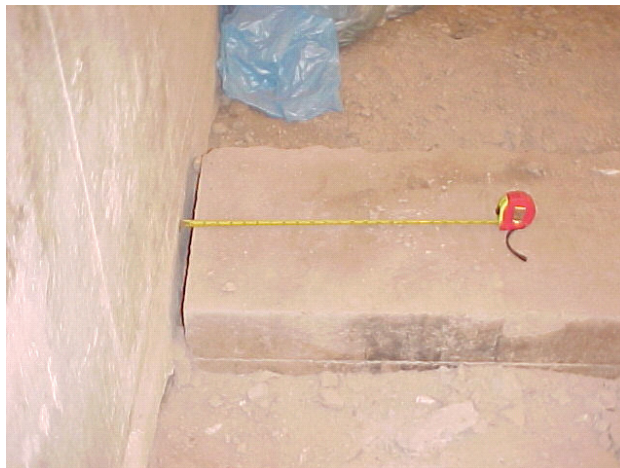
FIGURA 5.2 – Junta de dilatação na viga
