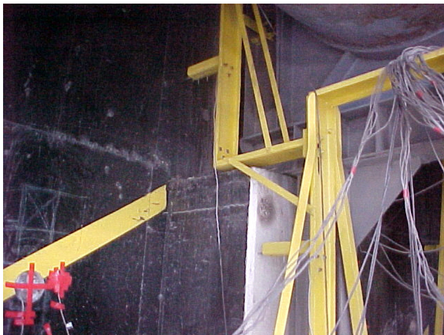
FIGURA 4.11 – Detalhe da monitoração do deslocamento.
