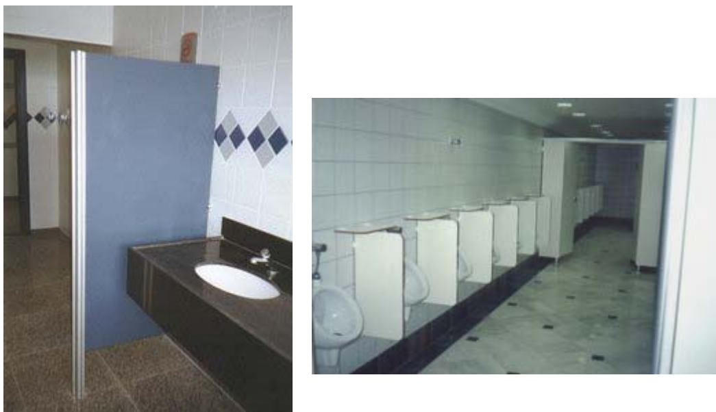
FIGURA 28 – Divisórias sanitárias empregadas como tapa vistas. Fonte: Site www.paineldivisorias.com.br .
