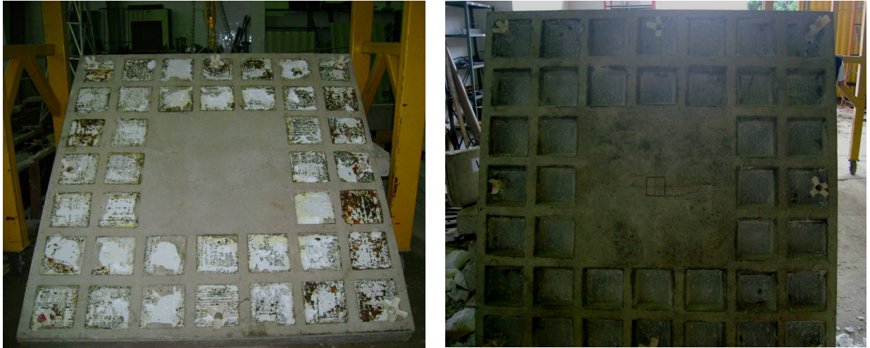
Figura 73 - Vista da parte inferior da laje antes e após a retirada dos blocos de EPS
