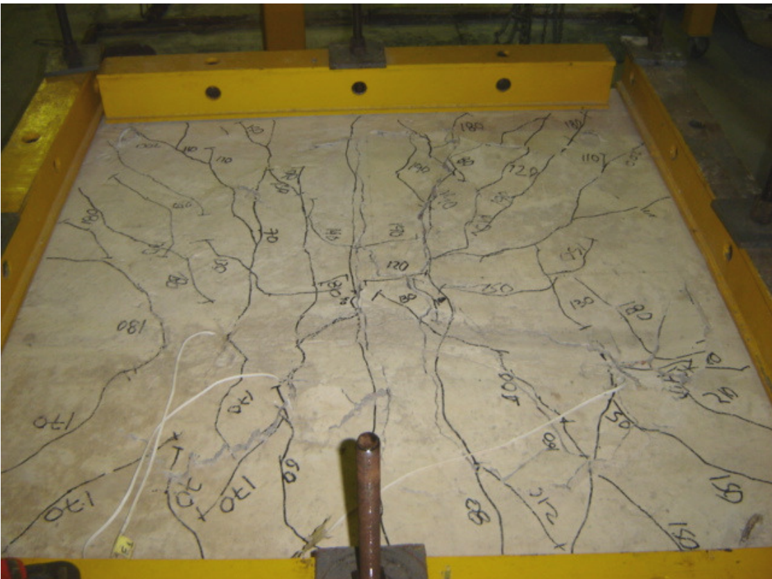
Figura 134 - Padrão de fissuração da laje L5
