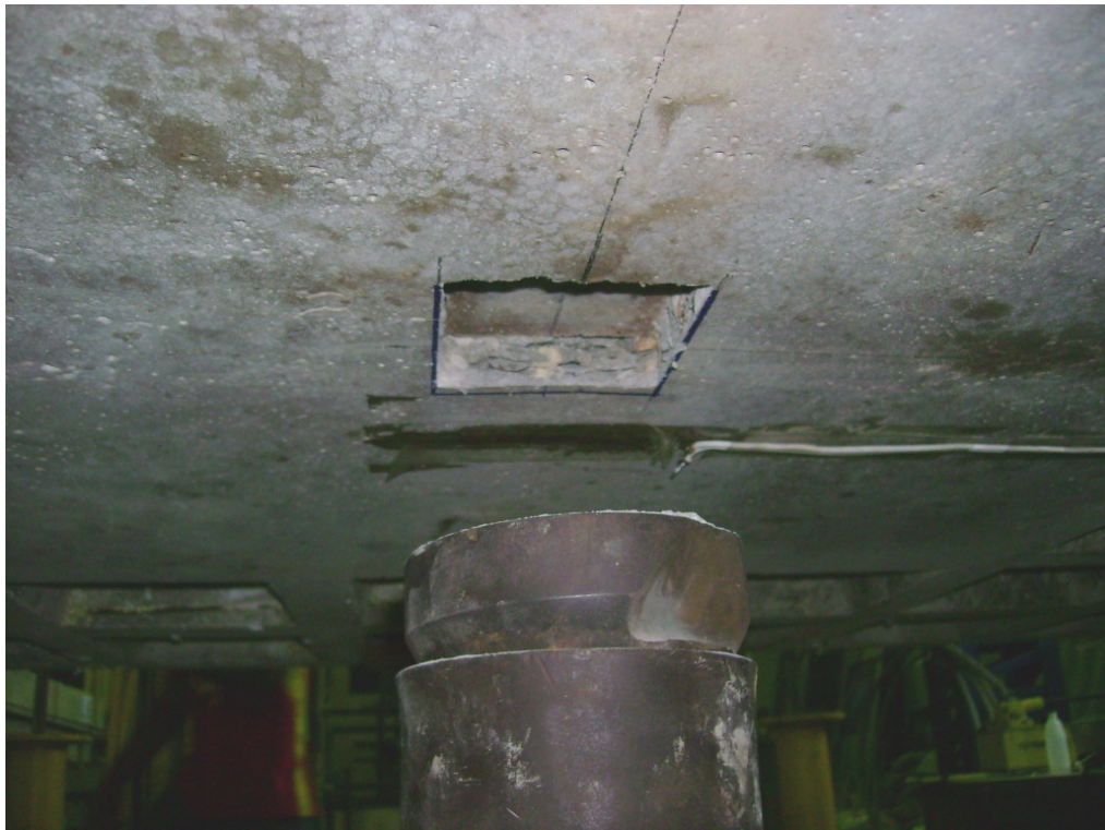
Figura 139 - Superfície de ruptura na face inferior das lajes
