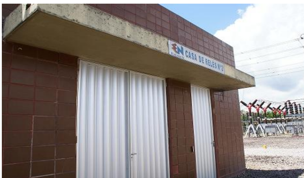
Figura 6.3 - Casa de relé da sub-estação Guamá, onde está instalado um medidor PS.
