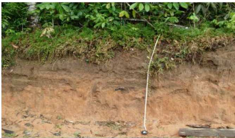
Figura 2.12: Solo superficial argilo-arenoso localizado em corte de Terraço Holocênico junto ao acesso da ECOMP.
