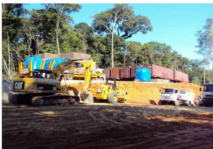
Praça 1 – Ponto de estocagem dos equipamentos antes dos mesmos seguirem para instalação.
