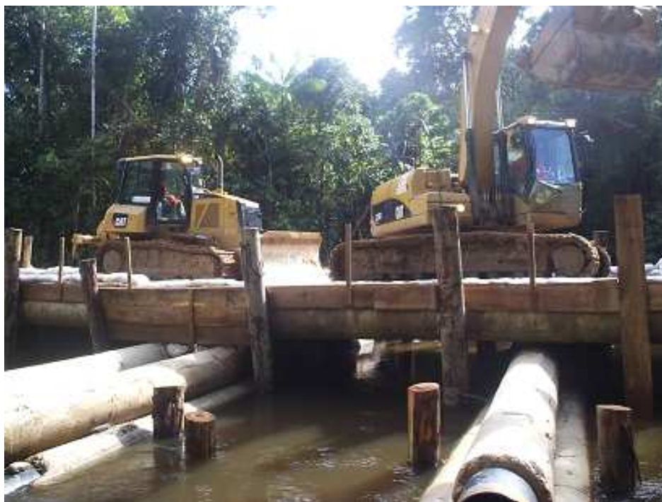
Construção da Ponte sobre o Igarapé do Cedro Prova de carga na Ponte sobre o Igarapé do Cedro para 100 toneladas
