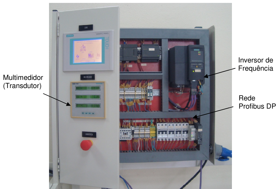
Figura 4.12: Painel de automação.
