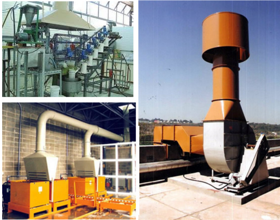
Figura 2.9 : Exemplos de Sistemas de Ventilação.
