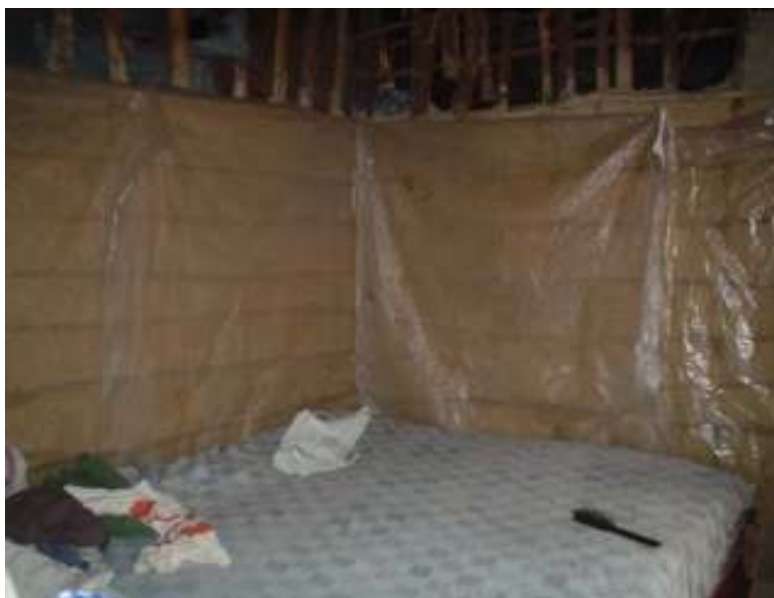
Fotografia 14 – Revestimento da parede do quarto da casa 1
