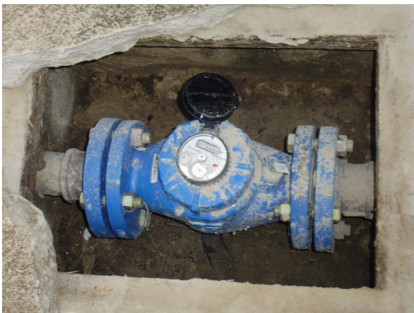
Foto 4.3- Hidrômetro instalado no ramal de alimentação do banheiro do Básico.
