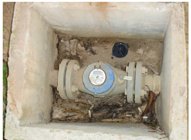
Foto 4.4- Hidrômetro instalado no ramal de alimentação do banheiro do Profissional.
