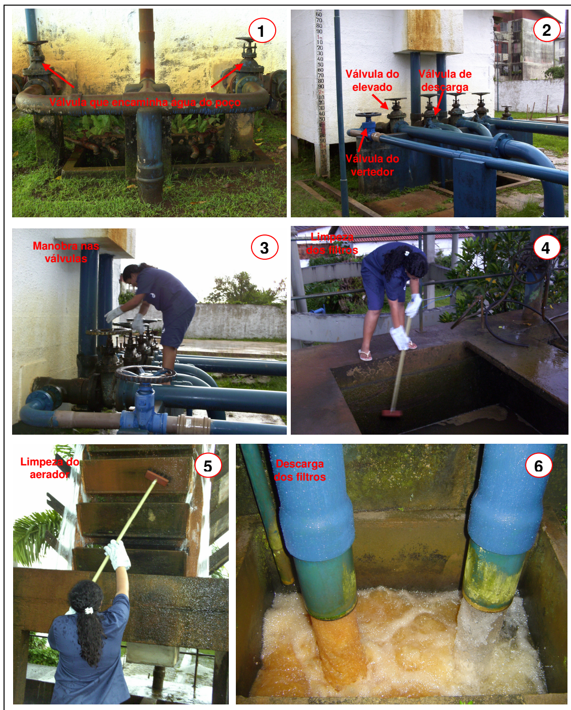
Figura 18: Procedimento para lavagem da ETA do Conjunto Benjamin Sodré
