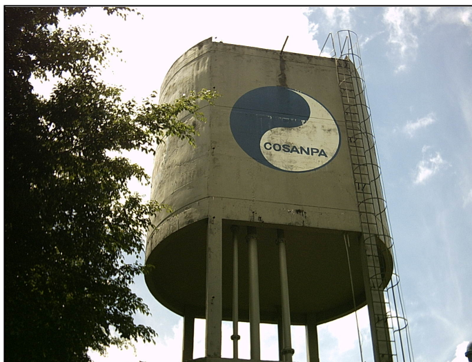
Fotografia 4: Vista do Reservatório Elevado do Conjunto Benjamin Sodré
