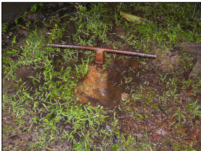
Fotografia 5: Válvula do poço do Conjunto Benjamin Sodré
