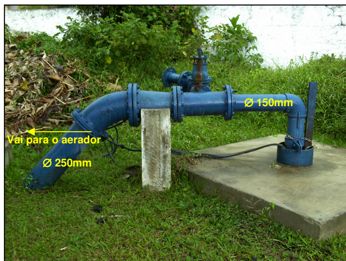
Fotografia 2: Poço de sucção do SAA do conjunto Benjamin Sodré Fonte: Direta (2008)
