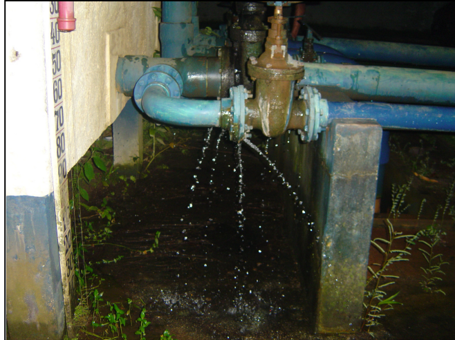
Fotografia 12: Vazamentos nas válvulas e conexões do Conjunto Benjamin Sodré
