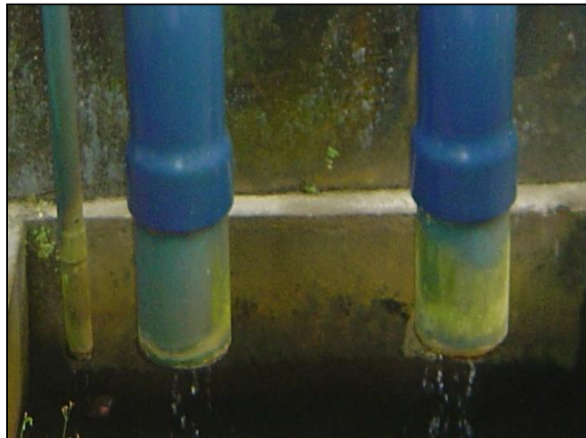
Fotografia 13: Vazamento permanente no Sistema de Abastecimento de Água do Conjunto Benjamin Sodré
