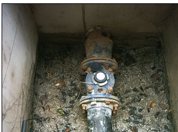
Fotografia 1: Macromedidor instalado na saída da ETA no Conjunto Benjamin Sodré
