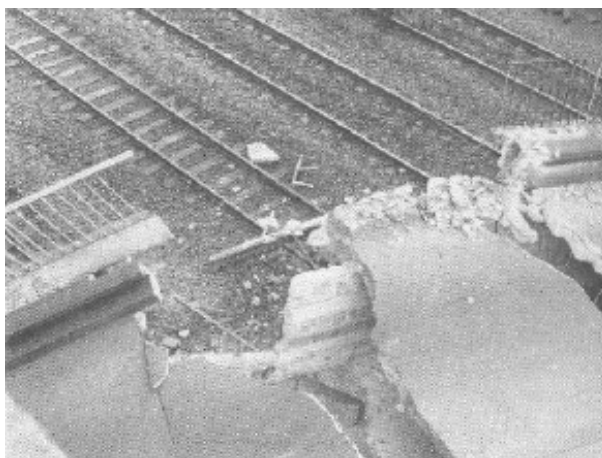
Figura 1-3 – Trecho do viaduto colapsado no Rio de Janeiro (Cunha et al. , 1998)
