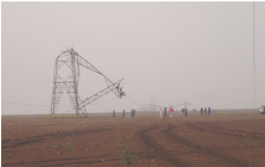
Figura 1-2 – Torre 196 colapsada componente da LT de 230 KV Caxipó/Sinop no Estado do Mato Grosso (Caldas, 2004)
