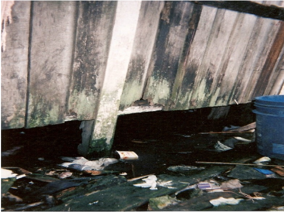
Figura 39 – Esgoto lançado diretamente sob residência do Riacho Doce. Fonte: Direta, 2007.
