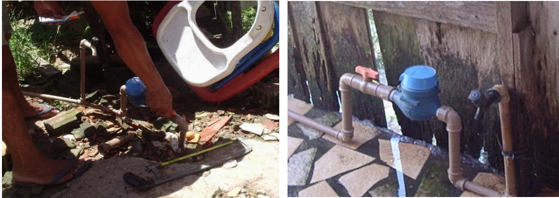
Figuras 24 e 25 – Instalações dos hidrômetros na área informal, Riacho Doce. Fonte: Direta, 2007
