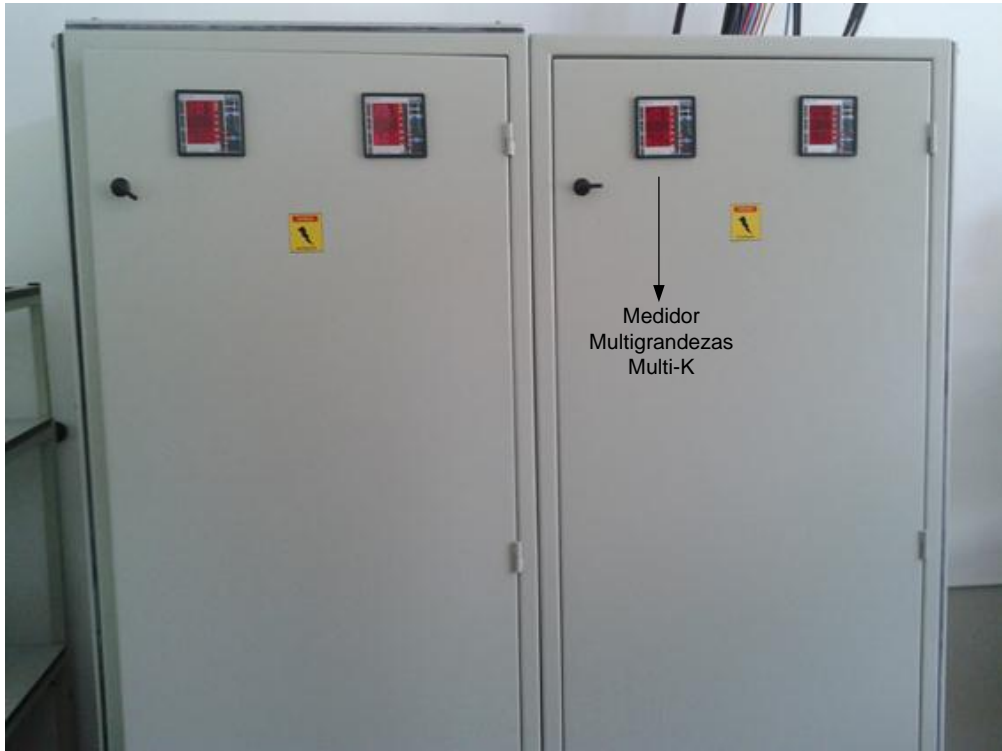
Figura 4.5 – Medidores multigrandezas instalados na porta do quadro geral de distribuição da edificação.
