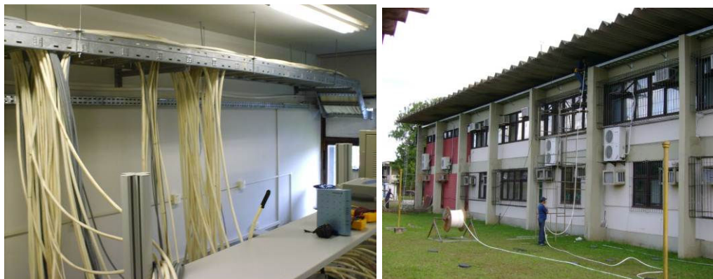
Figuras 6.5 e 6.6 - Cabos reais que rodeiam o prédio de Engenharia Elétrica
