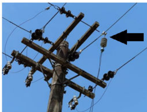
Figura 6.2 - Poste com acoplador que interliga o PLC
