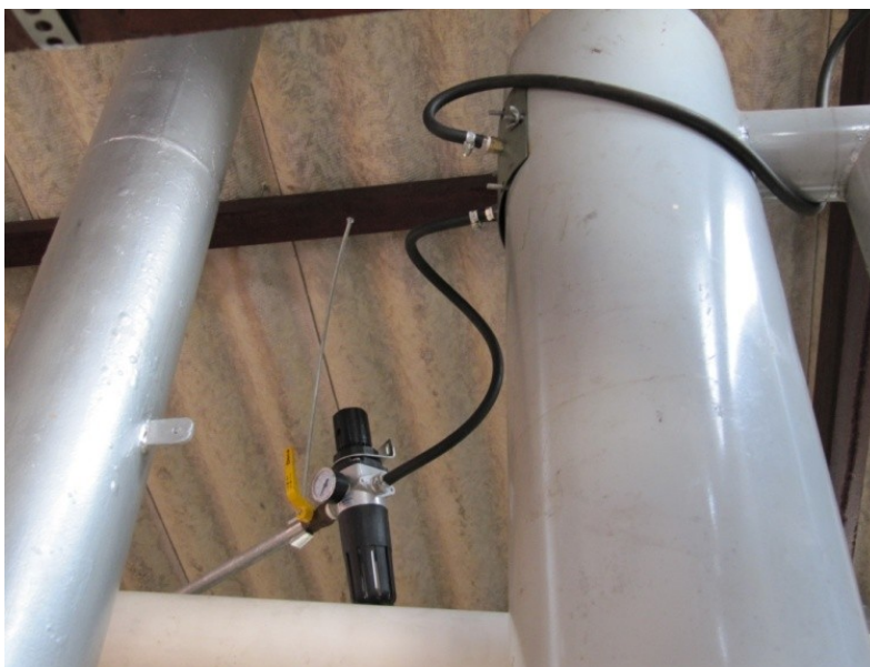
Figura 3.14 - Bico gerador de névoa montado no topo do trocador.
