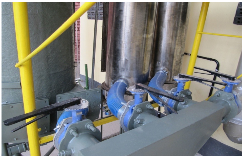
Figura 3.17 – Manifold (Distribuição de gases).
