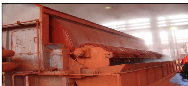
Figura III.4 – Decantador. Fonte: ALUNORTE (2008).
