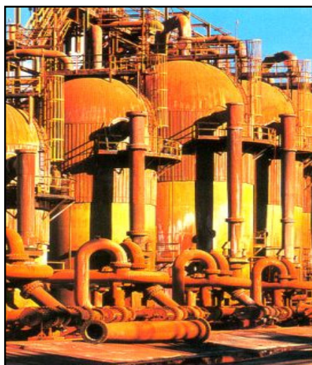
Figura III.3 – Digestores. Fonte: ALUNORTE (2008).
