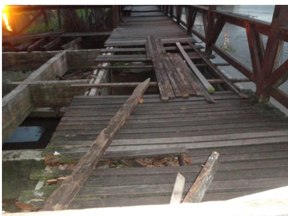
Figura 11: Piso de madeira quebrado.
