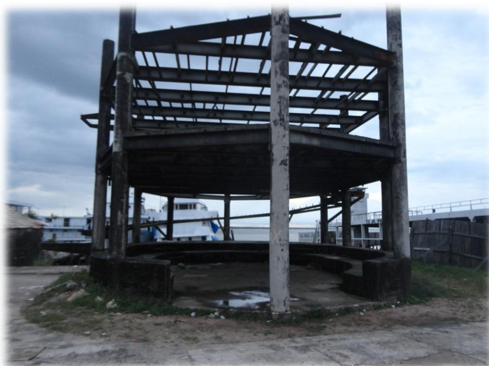
Figura 16: Obra inacabada do memorial dos povos negros e afro descendentes
