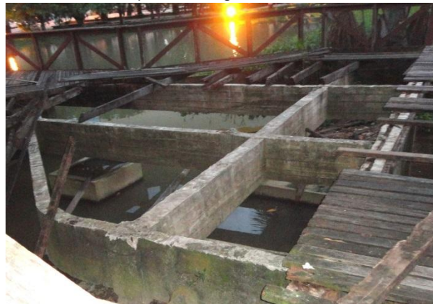
Figura 15: estado atual do piso de acesso ao memorial dos povos indígenas.
