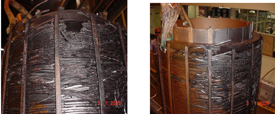
Figura 22. Falha em transformador elevador 13,8 kV - 70 MVA (Volume de Óleo: 25.000 L, Tipo de óleo: N - 10)
