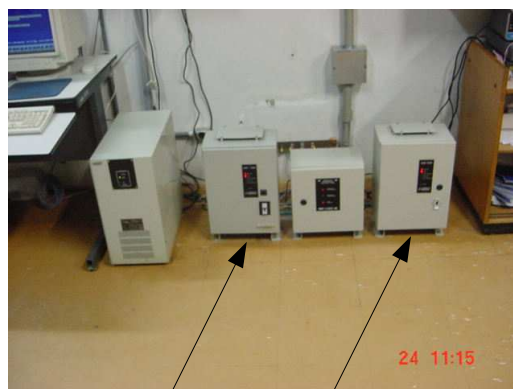
Inversores de 1kVA
