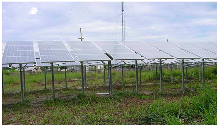
Figura 20: Gerador fotovoltaico: arranjos série-paralelo com módulos FV de 80Wp.
