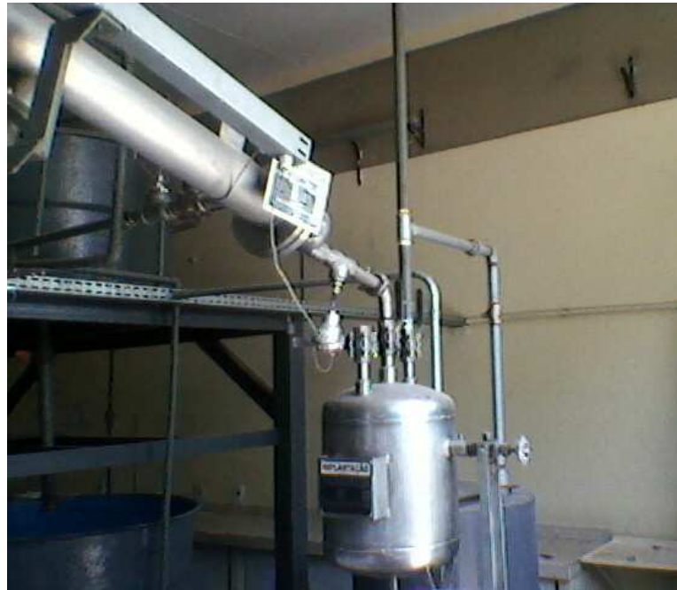
Figura 18 .- Condensador Double Piper e tanque de coleta
