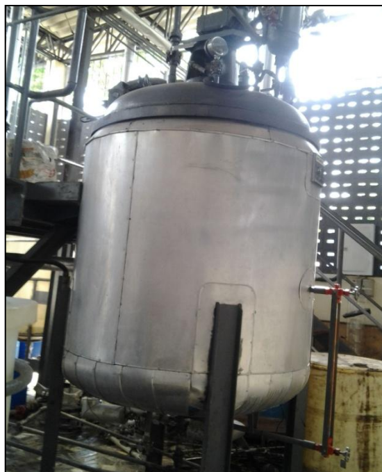
Fig.4.2 – Reator de pré-tratamento da borra.
