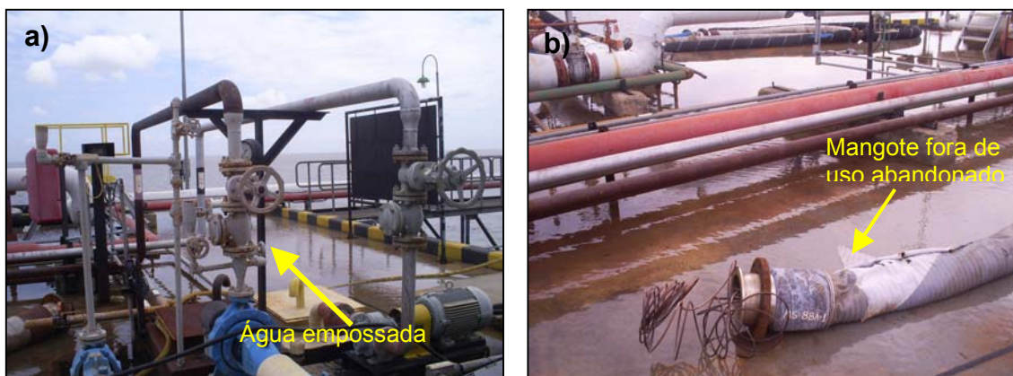
Figura 8 - (a) Acumulo de água entre os equipamentos de transferência de óleo combustível; (b) mangote abandonado no píer.
