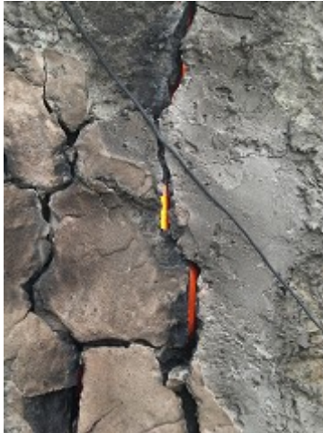
Figura 6-34 – Rachadura na parede da câmara durante a queima.
