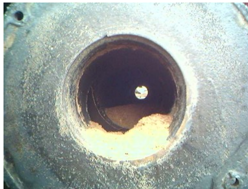
Figura 5-21 – Duto de sucção de ar e serragem.
