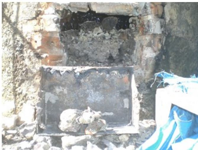
Figura 6-36 – Janela de inspeção inferior destruída após uma queima.
