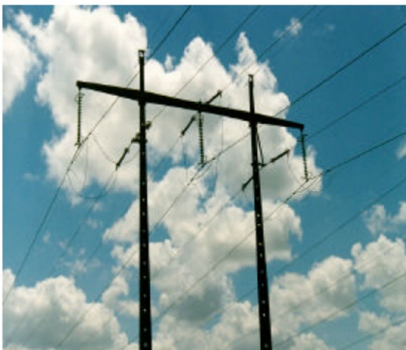
Figura 1.1 – Linha aérea de transmissão
