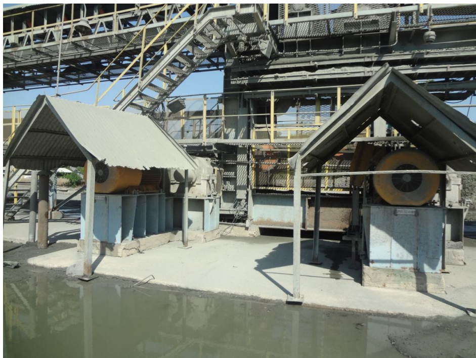
Figura 7.17- Sistema de acionamento da correia transportadora de cobre no estado do Pará.
