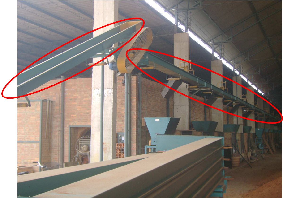
FIGURA 8.12 – Automatismo de queima para fornecimento de biomassa aos dosadores Fonte: Cerâmica Gama LTDA
