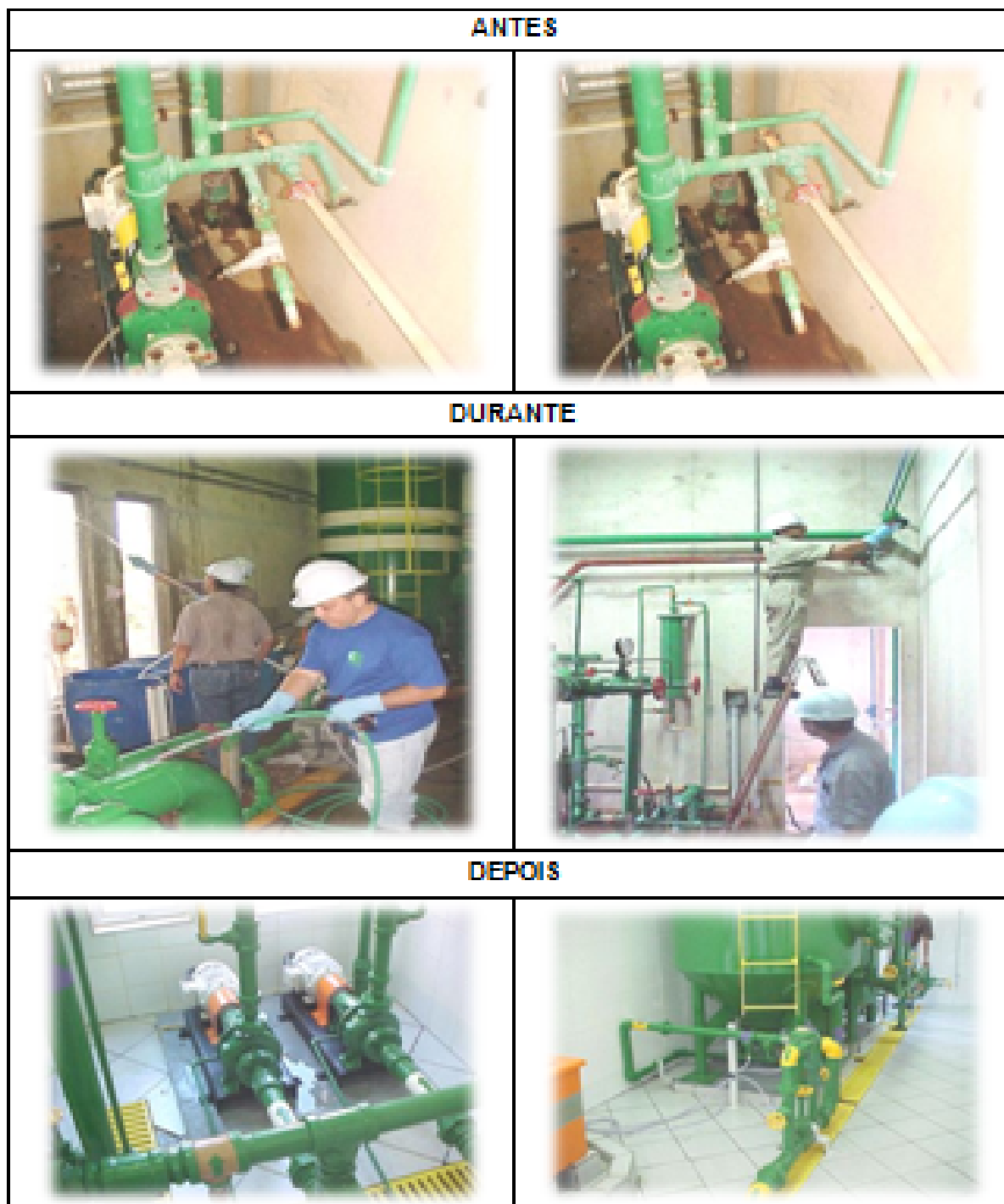
Figura 8: Equipamento modelo da UHE Samuel: Estação de tratamento de água
