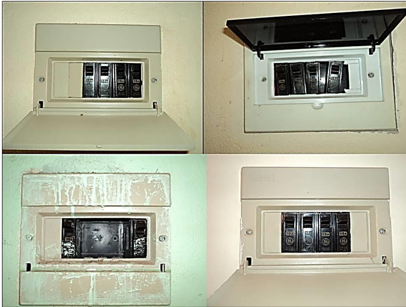
Figura 33 - Visão do quadro de disjuntores no interior das residências.
