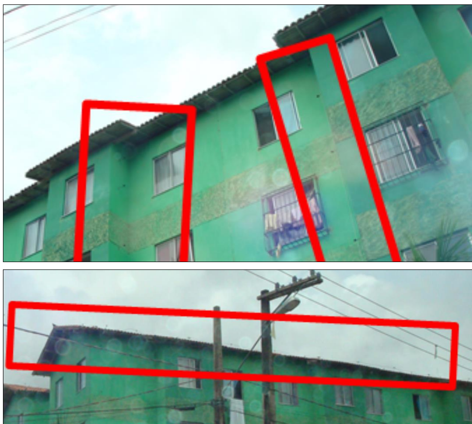
Figura 36 – Detalhes do SPDA e furto dos cabos de aterramento.
