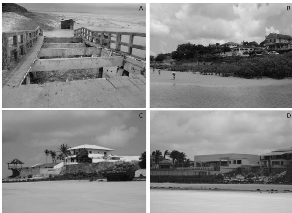
Figura 43 – Indícios de erosão nas principais praias de Salinópolis se traduzindo por: destruição da ponte que interliga a “orla do Maçarico” à praia da Corvina (A); desmoronamento gradativo de muros de arrimo na foz do Rio Sampaio, praia do Maçarico (06/10/2013) (B), nas praias do Farol Velho (C) e Atalaia (D). Fotografias retiradas em 26/04/2013 (A) e 06/10/2013 (B, C e D).
