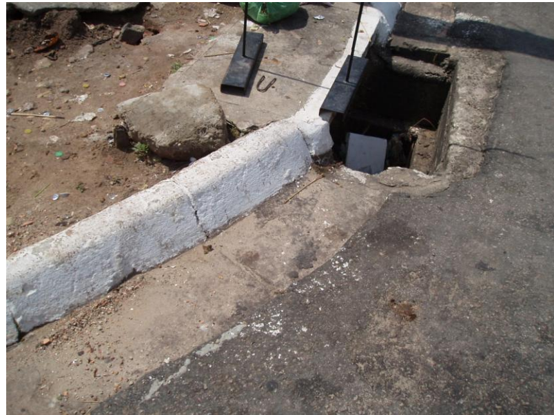
Fotografia 12 – Belém - Av. João Paulo II – Bueiro sem tampa.
