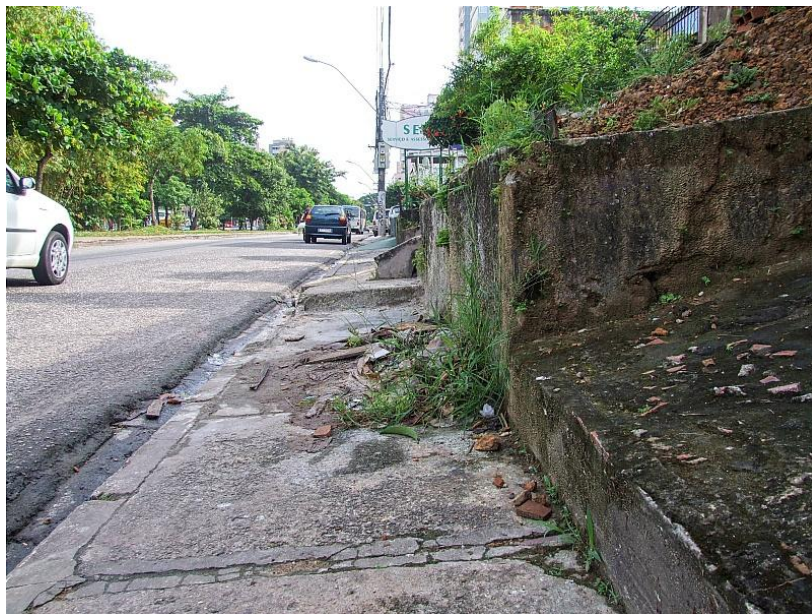
Fotografia 8 - Belém – Av. Marquês de Herval – Calçadas inacessíveis.
