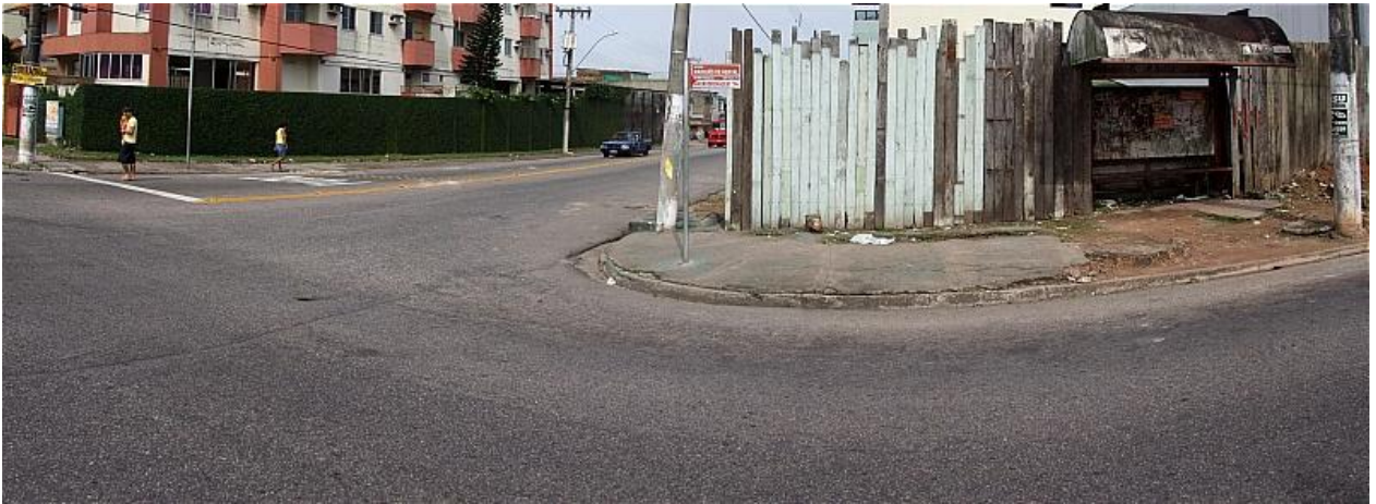
Fotografia 52 (panorâmica) – Belém - Av. Marquês de Herval – Calçada deteriorada e tapume.
