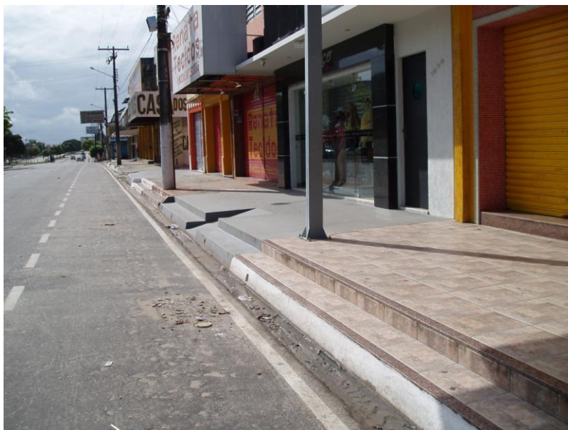
Fotografia 77 – Capanema – Degraus e desníveis nas calçadas.
