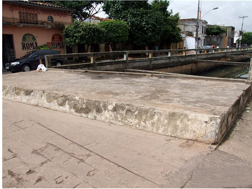
Fotografia 21 – Belém - Trav. Teófilo Conduru – Calçada alta e falta de anteparo.
