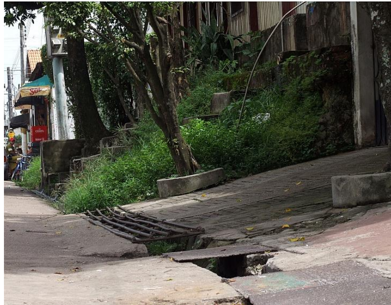
Fotografia 22 – Belém - Trav. Teófilo Conduru – Obstáculos no lugar da calçada.
