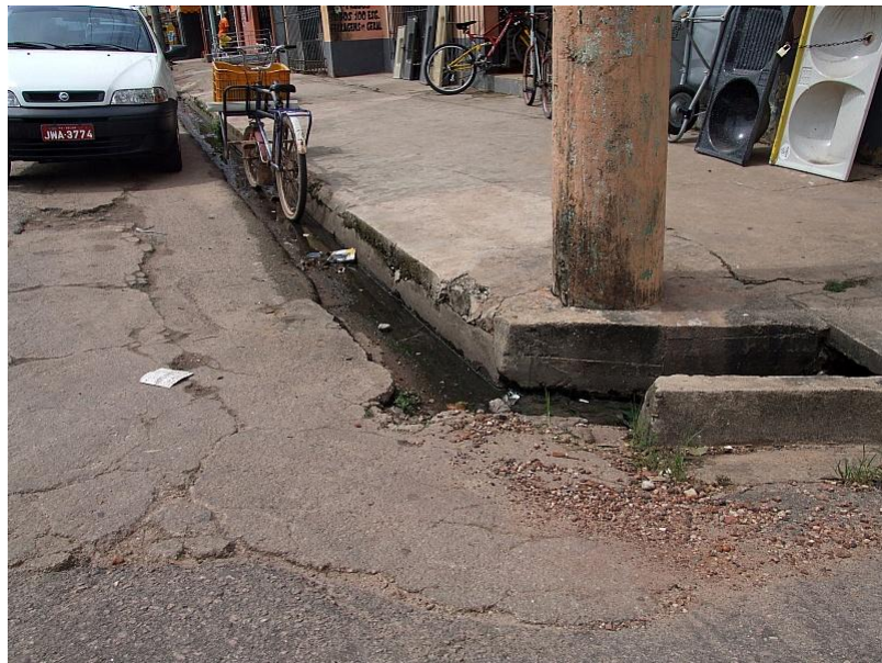
Fotografia 20 – Belém - Trav. Teófilo Conduru – Bueiro e falta de rebaixamento.
