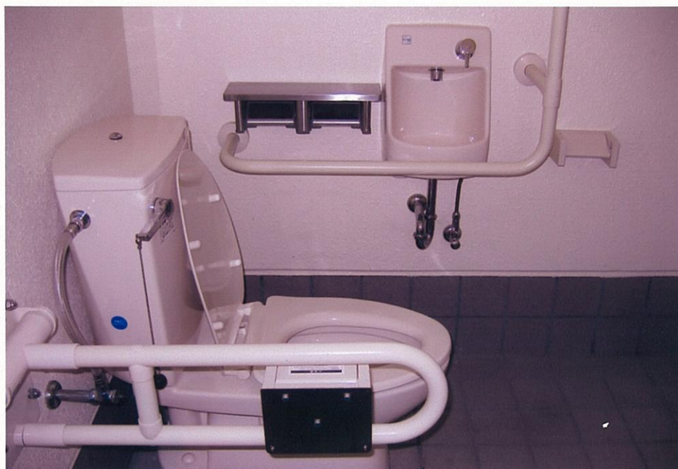
Fotografia 93 – Japão – Cidade de Hamamatsu – Interior dos banheiros para pessoas com necessidades especiais.
