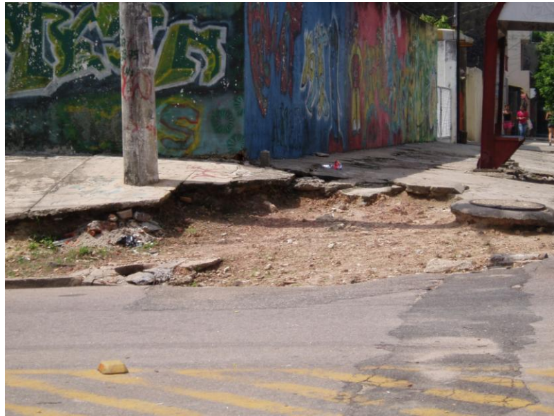
Fotografia 16 – Belém - Av. João Paulo II – Esquina com piso deteriorado.
