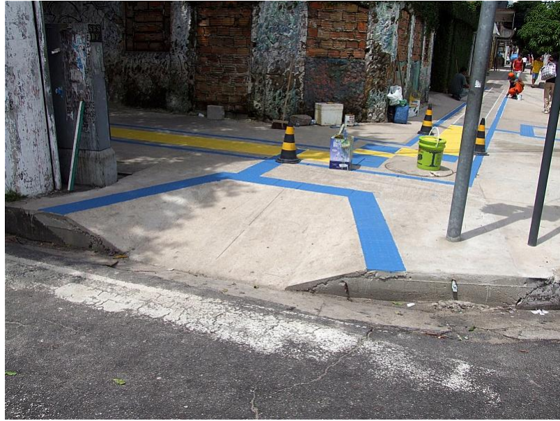
Fotografia 25 – Belém - Av. Gov. José Malcher – Rebaixamento e piso diferenciados.
