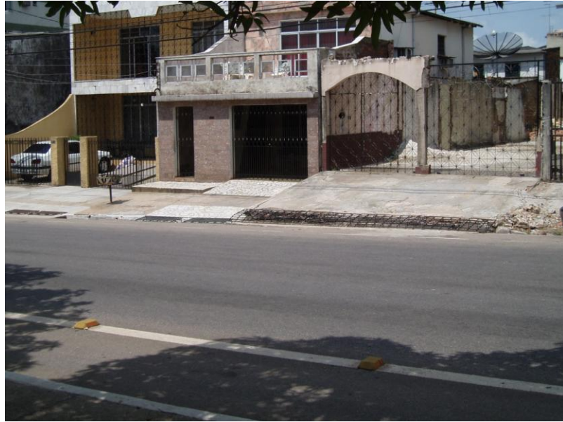
Fotografia 15 – Belém - Av. João Paulo II – Calçadas desniveladas.
