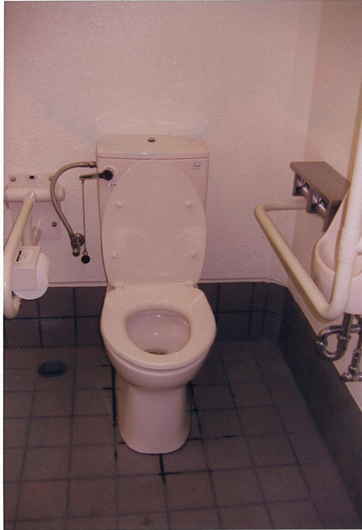
Fotografia 94 – Japão – Cidade de Hamamatsu – Interior dos banheiros para pessoas com necessidades especiais.
