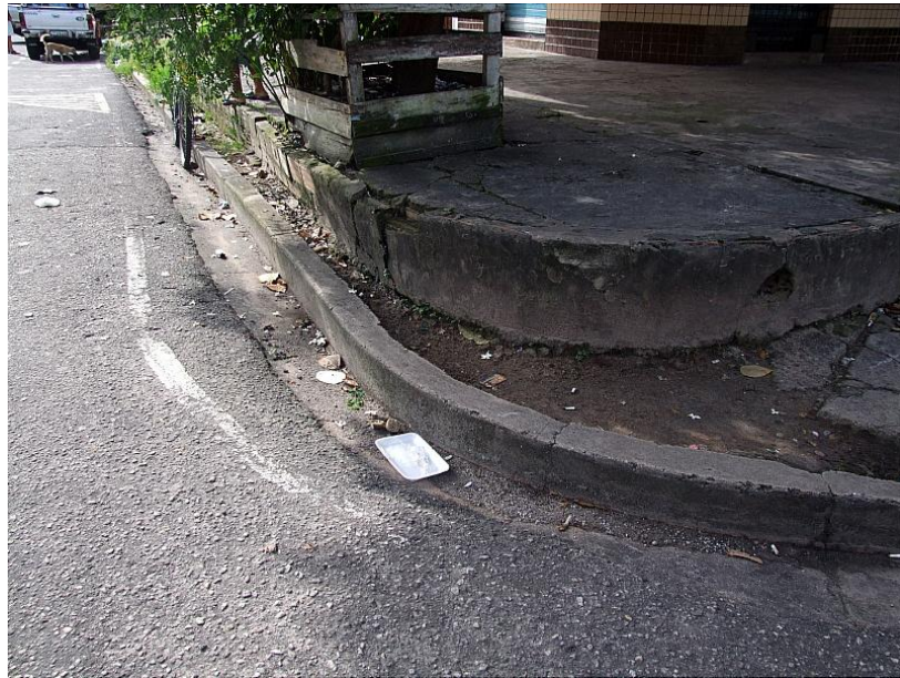
Fotografia 7 - Belém – Av. Marquês de Herval - Obstáculos na esquina.
