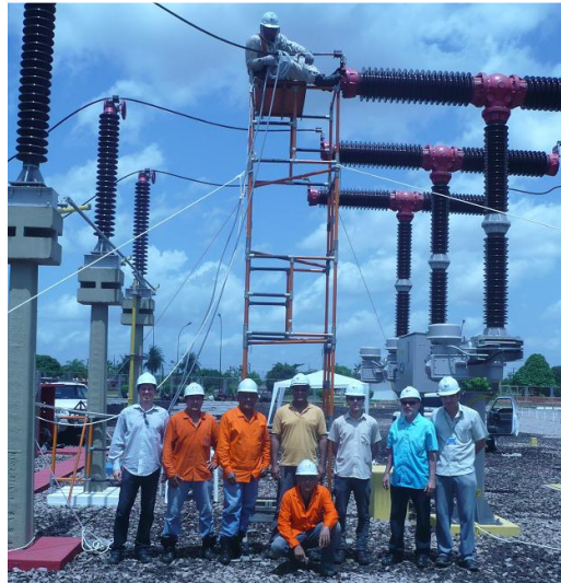
Figura 39 – Laço sensor de fibra ótica instalado no barramento energizado de 230 kV – Banco de capacitores 1 – SE Utinga.
