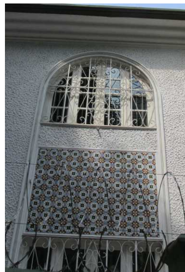
DET. 04: Painel com azulejos localizado abaixo de uma esquadria de madeira e vidro com gradil de ferro ornamentado.
