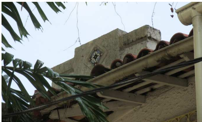
DET. 02: Detalhe do frontão com um azulejo central, presente na cobertura da edificação.
