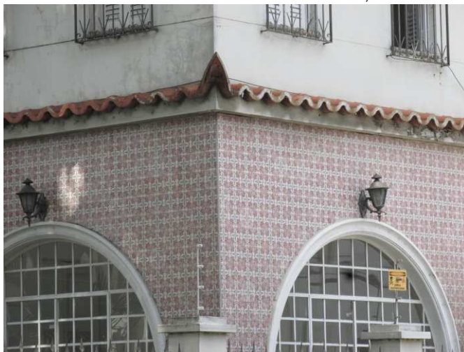
DET. 05: Detalhe da parede azulejada da edificação. Na parte superior de cada arco, há uma arandela presente.
