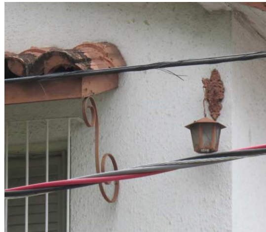
DET. 02: Presença de arandela e apoio em ferro na cobertura da esquadria.
