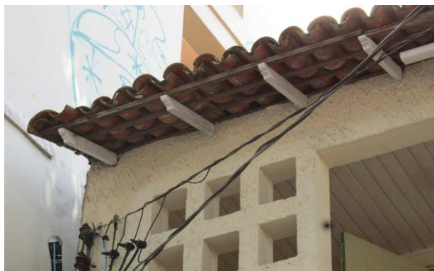
DET. 02: Utilização de telha capa canal na cobertura e de cachorros no beiral.
