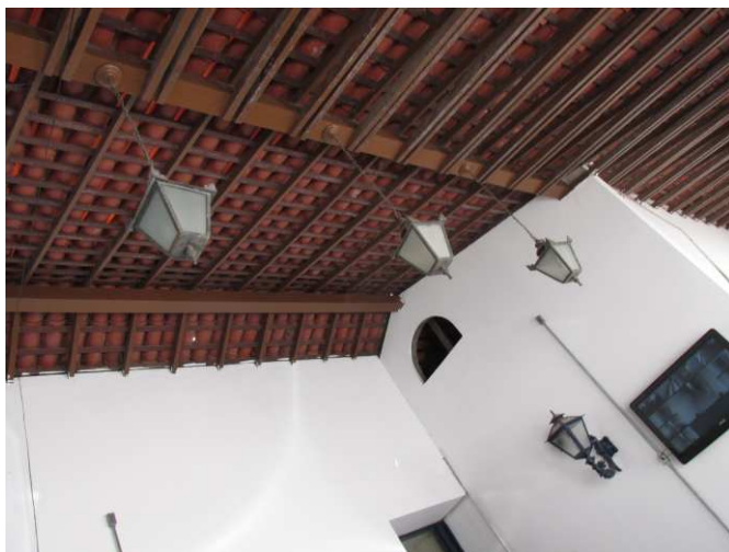
DET. 07: Área de circulação com luminárias presas na estrutura do telhado, além de uma arandela presa na parede. O madeiramento da edificação é diferenciado, sendo que em alguns trechos, os caibros estão duplicados.
