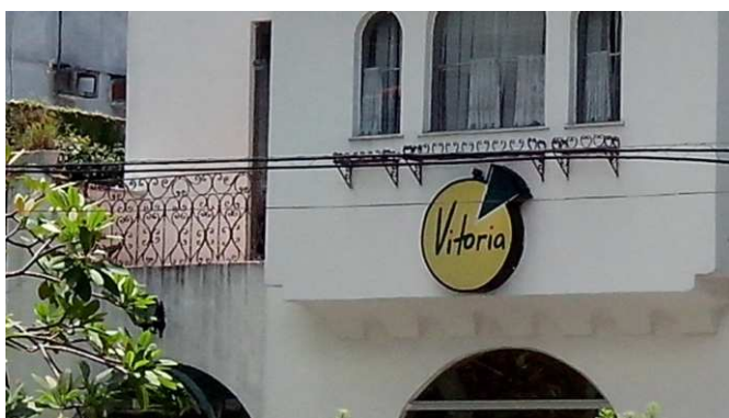
DET. 06: Detalhes em argamassa presentes abaixo da sacada, além de parte da sacada de alvenaria com detalhes de ferro. Foto: Amanda de Paula Bentes Pessoa, 2014.
