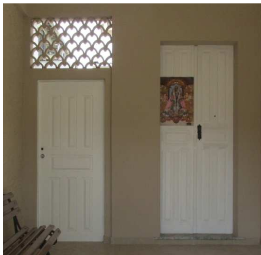
DET. 01: Detalhes das portas de madeira presentes na edificação. Ambas possuem almofadas e são pintadas de branco, contudo uma possui duas folhas, enquanto a outra possui uma folha. Em uma das portas há um painel vazado composto por peças de cimento, comum em algumas residências neocoloniais Foto: Bianca Barbosa do Nascimento, 2014.
