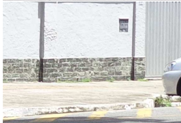
DET. 08 e 09: Mudança no tipo de embasamento presente no muro da residência. Anteriormente, o embasamento possuía uma textura chapiscada, atualmente o embasamento possui uma textura que remete a alvenaria.
