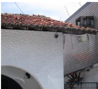
DET. 02: Detalhe de parte da cobertura e da parede da fachada principal. A cobertura é feita por telhas capa canal, enquanto as paredes da fachada possuem textura chapiscada na cor branca
