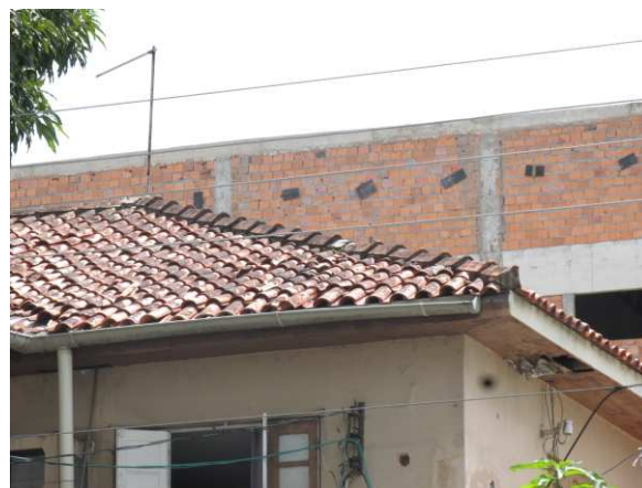
DET. 02: Detalhe de parte da cobertura da edificação, coberta com telha capa canal, e do beiral forrado com madeira.
