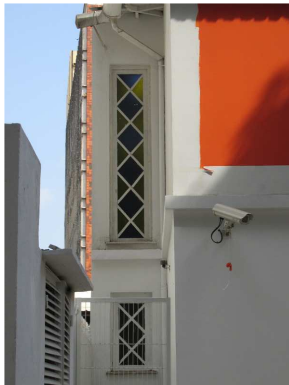
DET. 08: Janelas basculantes presentes em um dos recuos laterais do edifício. Essas janelas são de madeira e vidro, estilo treliçado e pintadas de branco. Em uma das basculantes, os vidros são de colorações diferentes.
