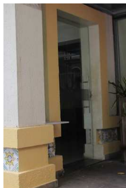
DET. 08: Entrada alternativa na parte lateral do edifício. Todas as esquadrias presentes nas fachadas principal e lateral estão descaracterizadas e atualmente são vedadas por vidro temperado.
