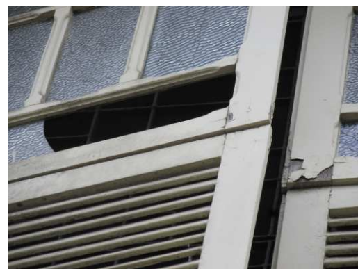
DET. 10: Sinais de deterioramento da esquadria de madeira.
