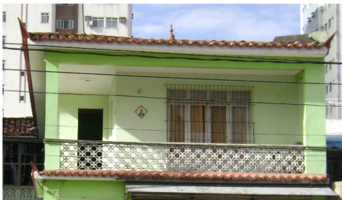
DET. 01: Detalhe de parte da fachada principal, onde é possível visualizar a varanda e a cobertura. A varanda possui um guarda corpo com vedação feita por cobogós. A cobertura é feita por telhas capa canal, com a presença de rabo de andorinha e pináculo.
