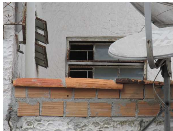
DET. 03: Detalhe de parte do muro que sofreu intervenção. Ao fundo da imagem é possível ver partes de duas janelas basculantes de alumínio e vidro.
