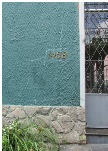
DET. 02: Detalhe da fachada principal. Nela é possível perceber a textura chapiscada da parede, o embasamento em pedra e o uso de gradil de ferro com ornamentação simples.
