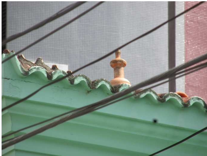
DET. 01: Detalhe da cobertura da edificação que utiliza telha capa canal e dos pináculos. Foto: Bianca Barbosa do Nascimento, 2014.
