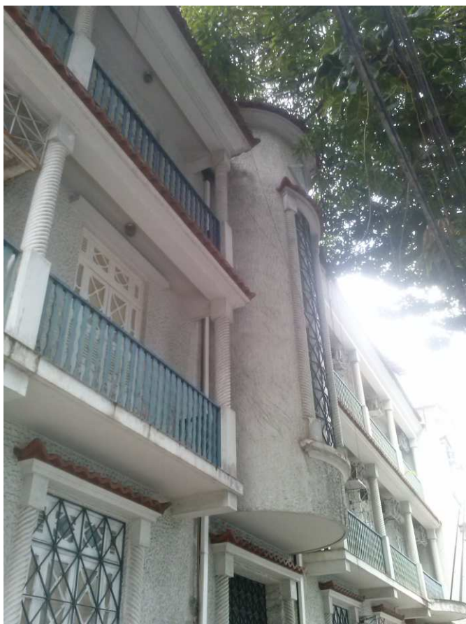
DET. 10: Parte da fachada voltada para a Tv Dr. Moraes, onde estão localizadas a torre, as varandas e um dos acessos para o interior do edifício. Foto: Acervo DPHAC, 2006.
