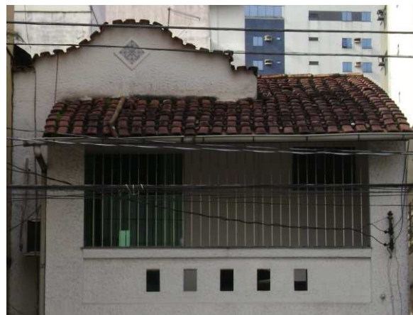
DET. 02: Parte do fachada principal onde encontram-se a varanda e o frontão. Nela é possível notar a parede chapiscada. A varanda passou por intervenções, onde foi adicionado um gradil simples de ferro, pintado de branco. Quanto ao guarda corpo, este possui apenas alguns elementos vazados como ornamentação. O frontão curvilíneo possui como ornamentação um azulejo no centro, além de estar coberto com telhas do tipo plan (o mesmo tipo de telha usada na cobertura) Foto: Felipe Moreira Azevedo, 2013.
