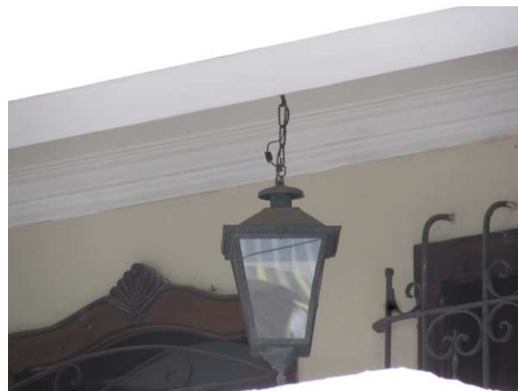
DET. 09: Uma das luminárias presentes na edificação.
