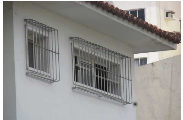
DET. 08 e 09: Detalhe das esquadrias basculantes presentes nas fachadas laterais da residência. Ambas são de madeira e vidro, além de serem pintadas na cor branca e possuírem um gradil de ferro com ornamentação simples ao seu redor.
