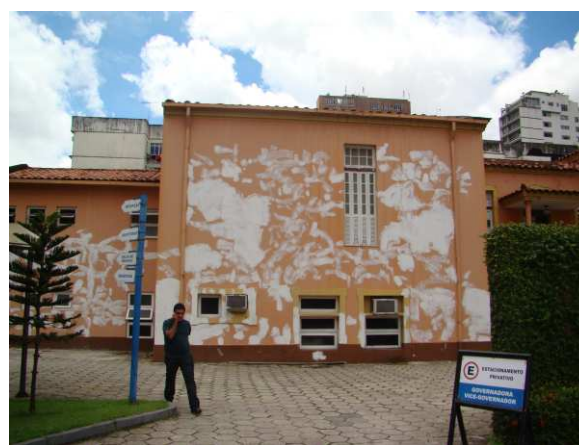
DET. 10: Parte de uma das fachadas laterais, onde é possível notar o uso de diversas esquadrias basculantes de madeira e vidro, pintadas de branco.
