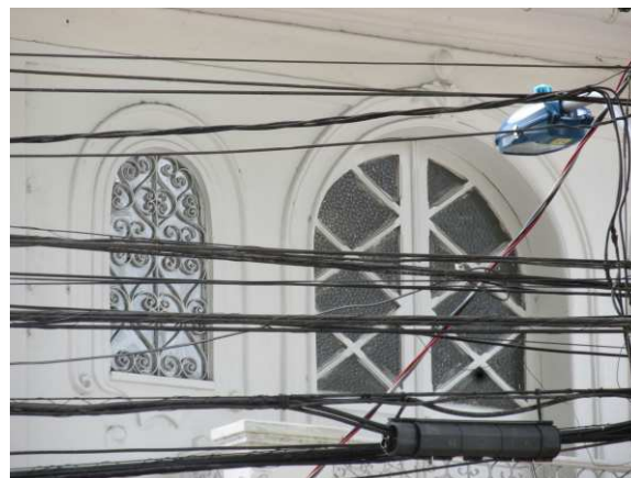
DET. 04: Detalhe de duas das esquadrias da fachada principal. Uma é de madeira e vidro, estilo treliçado com um arco, enquanto a outra possui estrutura de vidro com ornamentação e vedação em vidro.
