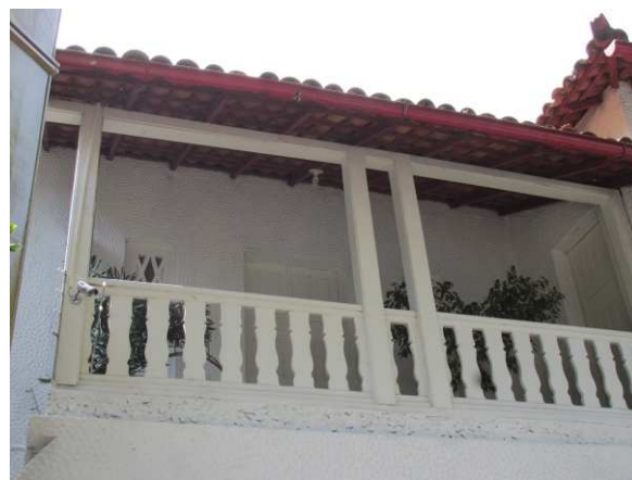
DET. 04: Varanda da fachada principal. O guarda corpo de todas as varandas presentes na residência são de madeira com desenhos que remetem a balaústres. Os pilares de sustentação da varanda são de madeira.
