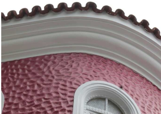
DET. 06: Detalhe de parte da cobertura que é composta por telhas capa canal e apresenta um beiral com frisos. Foto: Bianca Barbosa do Nascimento, 2014.
