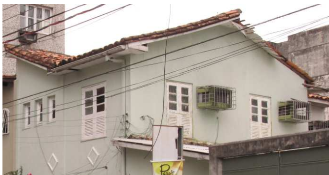
DET. 05: Presença de esquadrias de madeira e vidro, estilo venezianas, além de três janelas basculantes no 1º pavimento da residência. Na cobertura, nota-se a existência de um forro de madeira cobrindo o beiral, sendo que parte dele está deteriorado.
