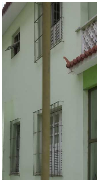
DET. 03: Detalhe da fachada lateral, que possui dois diferentes tipos de esquadria: com estrutura de madeira pintada de branco e vedação de vidro, estilo veneziana, sendo que estas possuem gradil simples de ferro; e uma janela basculante de madeira e vidro.
