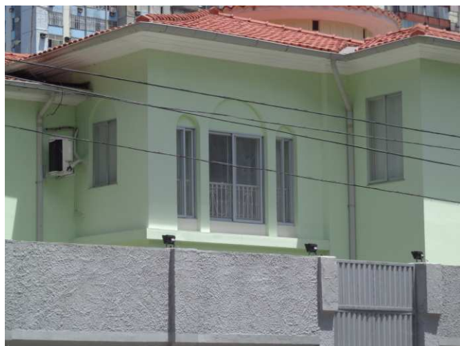
DET. 07: Apenas o gradil de ferro simples, que servia como guarda corpo, da janela do 1º pavimento e as molduras de argamassa no espaço das esquadrias se mantiveram em meio as intervenções realizadas na edificação.
