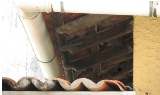
DET. 02: O beiral da cobertura possui cachorros ao longo da sua extensão.
