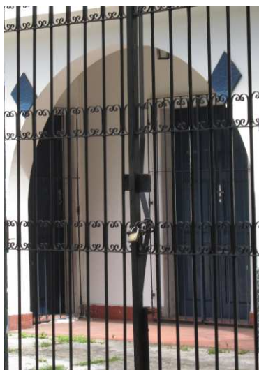
DET. 17 e 18: Detalhes da janela, das portas e dos arcos presentes na fachada. Na janela de alumínio e vidro, nota-se a silhueta de uma grade sanfonada que estaria do lado de dentro da edificação, além disso, há a presença de um elemento geométrico que serve como ornamentação. Na área de acesso à casa, há um arco com elementos geométricos com textura chapiscada. As portas de entrada são de madeira pintada de azul marinho, com duas folhas e almofadas simples. Estas também possuem grades de ferro simples.
