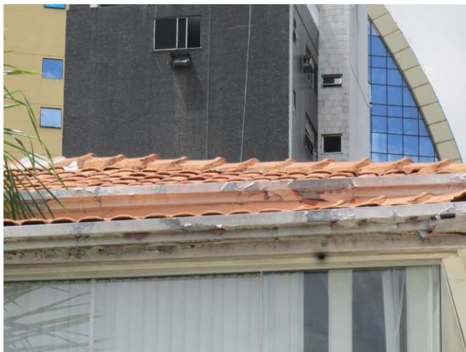
DET. 01: A edificação possui uma discreta composição de cobertura. Atualmente, o telhado é constituído de telhas plan. A cobertura não possui rabo de andorinha, nem cachorros. O beiral é composto apenas da calha, para a água da chuva que encobre as telhas. Foto: Bianca Barbosa do Nascimento, 2014.
