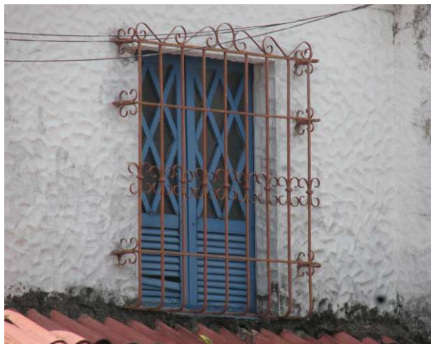
DET. 06: Detalhe de uma das janelas de madeira e vidro presentes na edificação.
