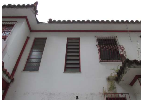
DET. 09: Janelas presentes na lateral do edifício. Duas delas são esquadrias basculantes de ferro e vidro, e a outra aparentemente é uma esquadria de madeira e vidro estilo veneziana, que possui gradil de ferro vazado, com uma curvatura na metade da sua extensão e pintado na cor vermelha.
