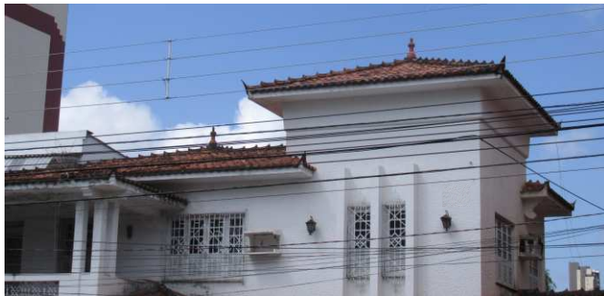
DET. 01: Composição de cobertura, uso de telha capa canal, rabo de andorinha e a presença de pináculos. Foto: Bianca Barbosa do Nascimento, 2014.
