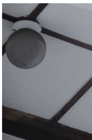
DET. 10: Luminária presente na varanda da edificação.
