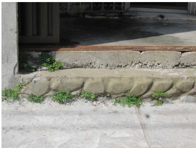
DET. 04: Parte do embasamento com textura imitando pedra que restou após as diversas intervenções que a edificação sofreu.
