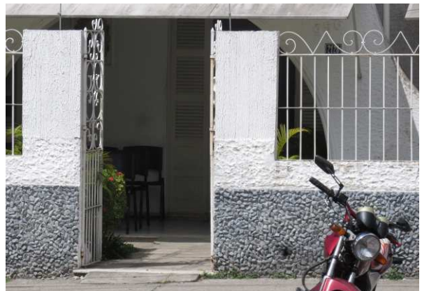
DET. 04: Detalhe do muro com embasamento composto por pequenas pedras pintadas da cor cinza. A diferença de texturas utilizadas nos pilares de sustentação entre as grades de ferro é um forte indício de que houve intervenções no muro.
