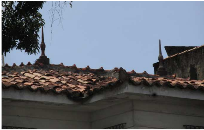
DET. 04: Detalhe da cobertura da edificação. As telhas são capa canal, com o uso de rabo de andorinha nos vértices, além da presença de dois pináculos no alto da cobertura.
