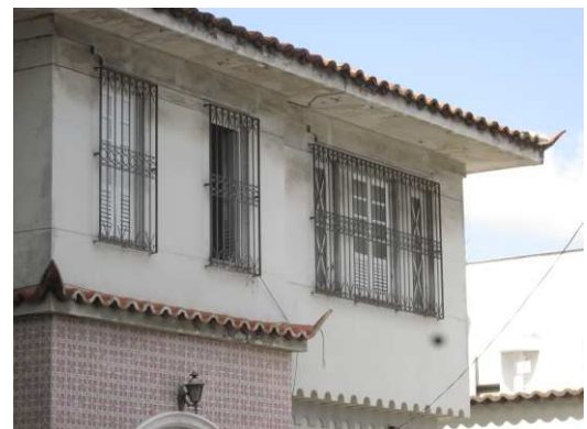
DET. 09: Janelas de madeira e vidro e somente de madeira do 1º pavimento. Ambas são de madeira pintada na cor branca. Quanto ao número de folhas, elas variam entre uma e duas folhas. Duas das esquadrias presentes são janelas fixas, estilo treliçado.
