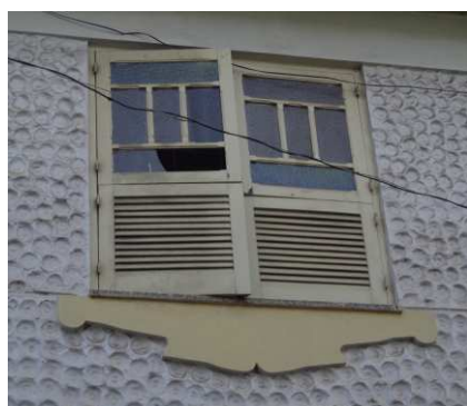
DET. 02: Moldura presente na parte inferior da esquadria.
