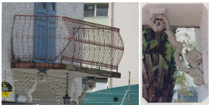
DET. 07 e 08: Sacada com guarda corpo de gradil simples. A imagem ao lado mostra o detalhe do ornamento que aparenta sustentar a sacada.
