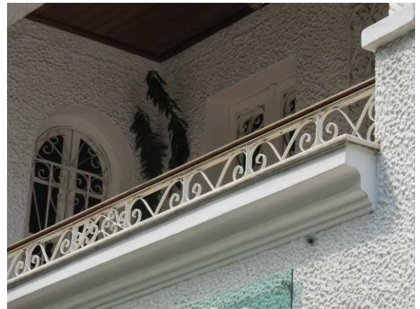
DET. 03: Detalhe do guarda corpo de ferro presente na varanda da residência. É possível notar também a textura chapiscada das paredes
