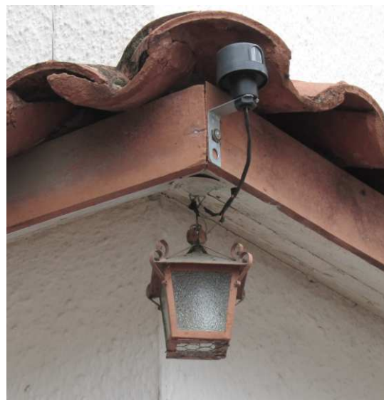
DET. 06: Detalhe da telha capa e canal e da arandela presente no canto da estrutura de madeira da cobertura e no forro de estuque. Foto: Bianca Barbosa do Nascimento, 2014.
