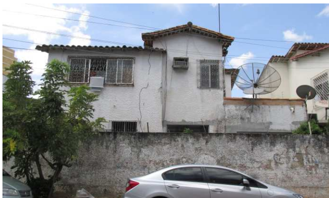
DET. 01: A edificação de dois pavimentos está em um péssimo estado de conservação, com grandes rachaduras nas paredes, algumas esquadrias deterioradas, entre outros. A casa já passou por algumas intervenções, mas ainda preserva algumas características neocoloniais, como a textura na parede e o uso de telha capa canal na cobertura.
