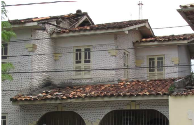
DET. 05: Composição de cobertura e uso de telhas capa canal, apresentando um forro de madeira no beiral. Contudo, em várias partes da cobertura, o forro está deteriorado.
