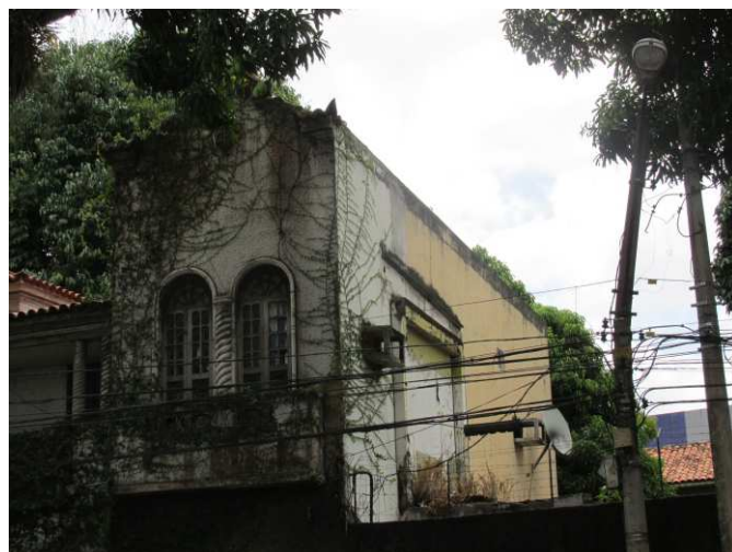
DET. 16: Indícios em uma das paredes da fachada de intervenções realizadas na residência.
