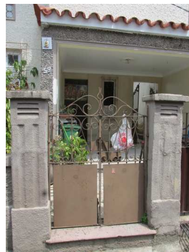
DET. 03: Sulcos feitos na superfícies dos pilares que compõe o muro.
