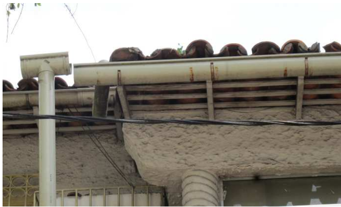
DET. 01: Detalhe de parte da varanda da edificação, cuja a viga possui textura chapiscada e acabamento em argamassa semelhante ao cachorros encontrados no beiral da cobertura.
