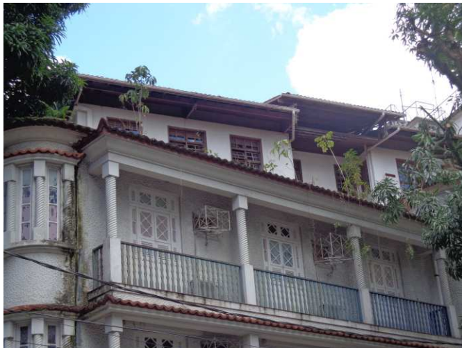
DET. 04: Detalhe do último pavimento da edificação, que assim como os outros, possui uma varanda com guarda corpo de madeira e colunas torsas distribuídas ao longo da circulação .
