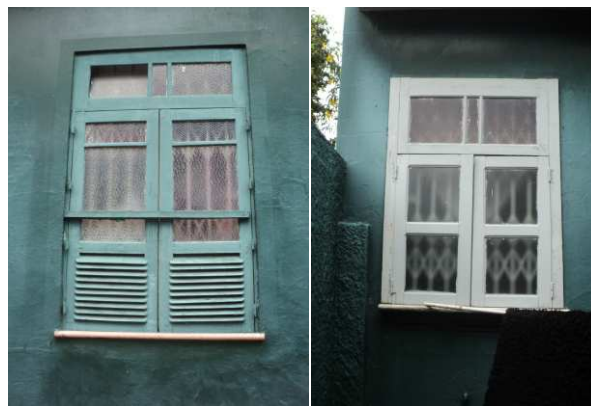
DET. 03 e 04: Outros tipos de esquadrias presentes na residência. Ambas são de madeira e vidro, contudo uma possui venezianas e a outra não. É possível notar que as duas esquadrias possuem grade sanfonada instaladas na parte interna da edificação.
