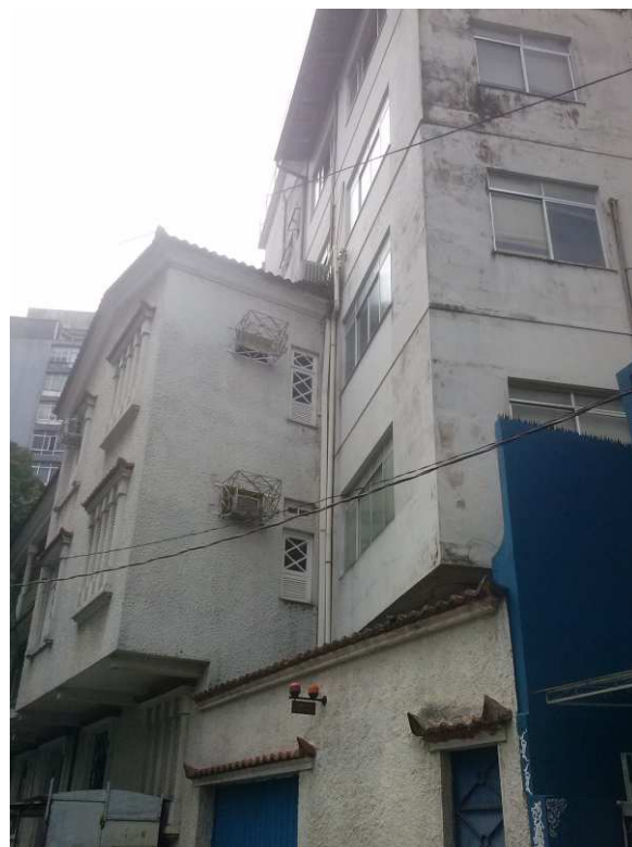
DET. 11: Imagem que mostra a relação entre o prédio neocolonial e seu anexo construído para atender as necessidades de ampliação que o órgão gestor do edifício sentia. Foto: Acervo DPHAC, 2006.
