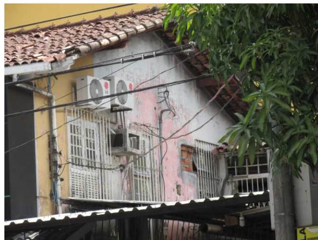
DET. 01: Detalhe da fachada lateral da edificação onde é possível notar o uso de telhas capa canal na cobertura, e de cachorros ao longo do beiral. Na fachada lateral, há a presença de algumas janelas de madeira, pintadas de branco, vidro, estilo venezianas com duas folhas, juntamente com um gradil de ferro com ornamentação simples, também pintado de branco.
